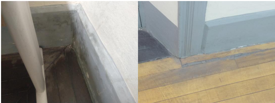
Figura 20 – Pontos de desgaste excessivo do piso de madeira
