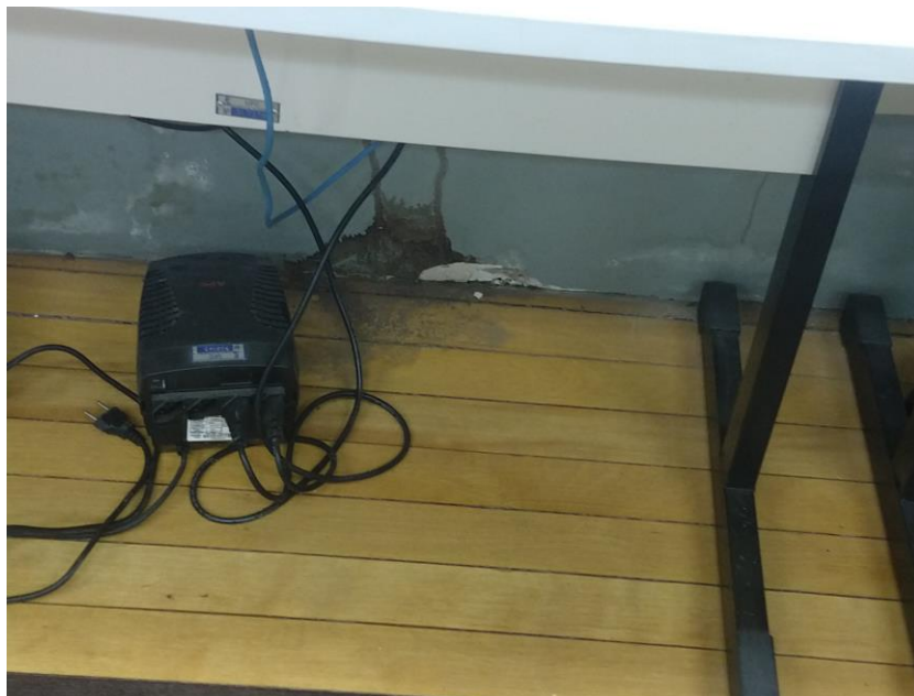
Figura 21 – Presença de cupins no piso de madeira
