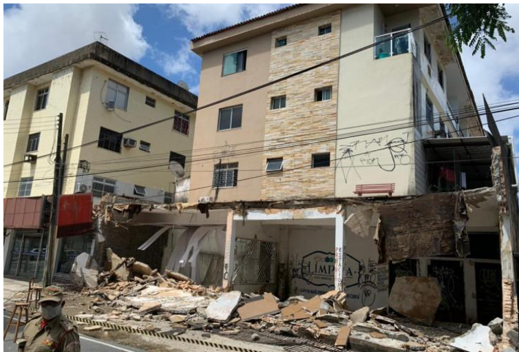
Figura 6 – Desabamento de uma laje de um edifício residencial no bairro Dionísio Torres
