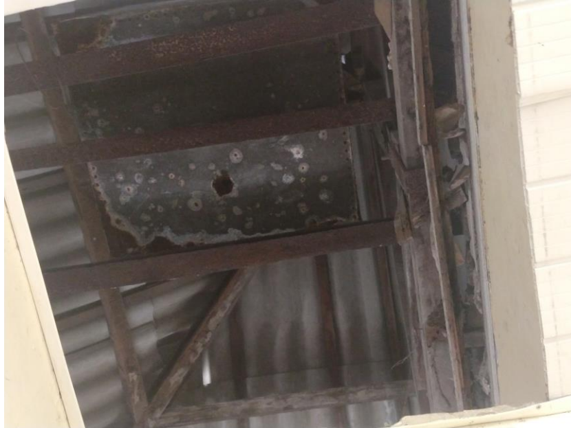
Figura 29 – Presença de ferrugem na estrutura de suporte do telhado
