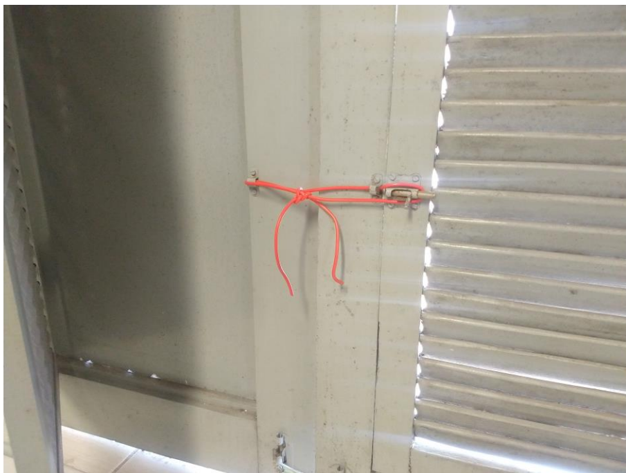
Figura 27 – Janela com improvisação para suprir a falta de ferrolho
