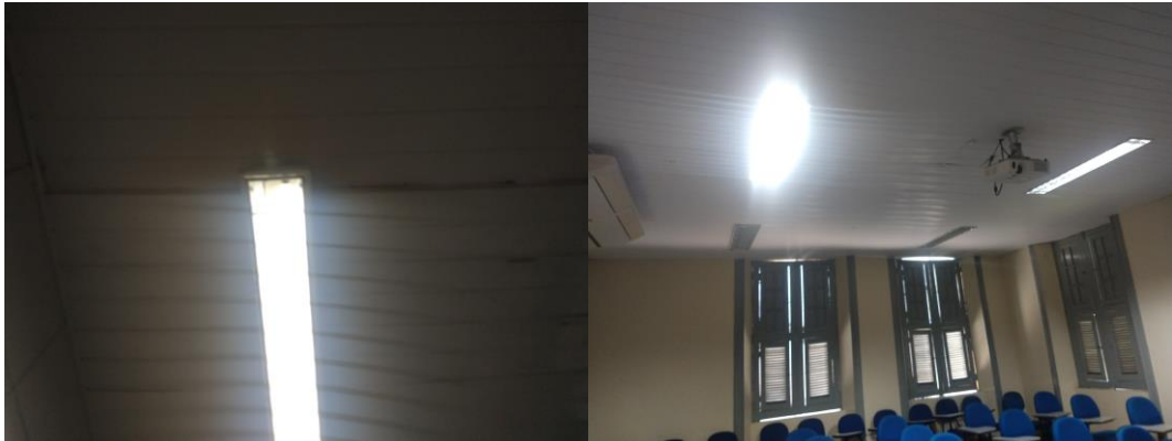
Figura 31 – Presença de ondulações no forro de PVC
