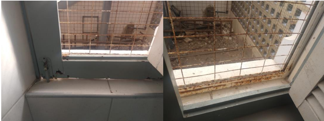
Figura 28 – Presença de ferrugem nas grades de proteção dos banheiros
