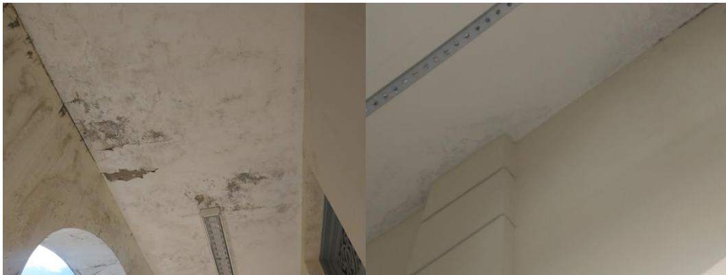
Figura 12 – Pontos de infiltração nas lajes dos corredores
