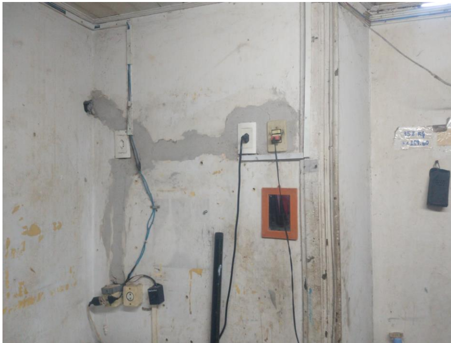
Figura 33 – Presença de fiação irregular com fios expostos
