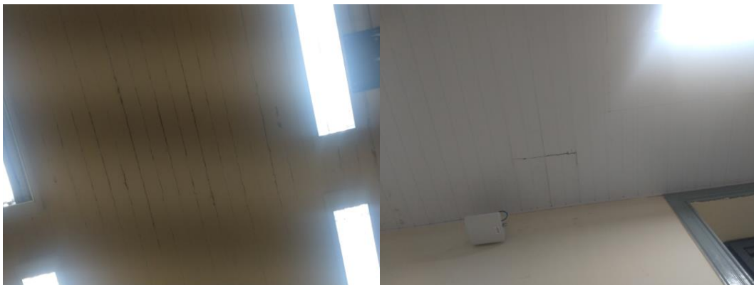
Figura 30 – Forro de PVC com falhas
