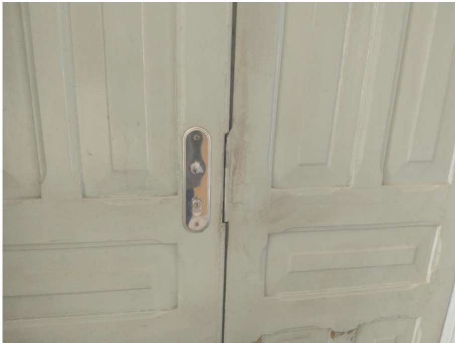
Figura 25 – Porta sem a presença de maçaneta para utilização
