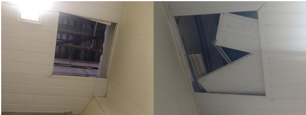
Figura 32 – Forro de PVC com furos
