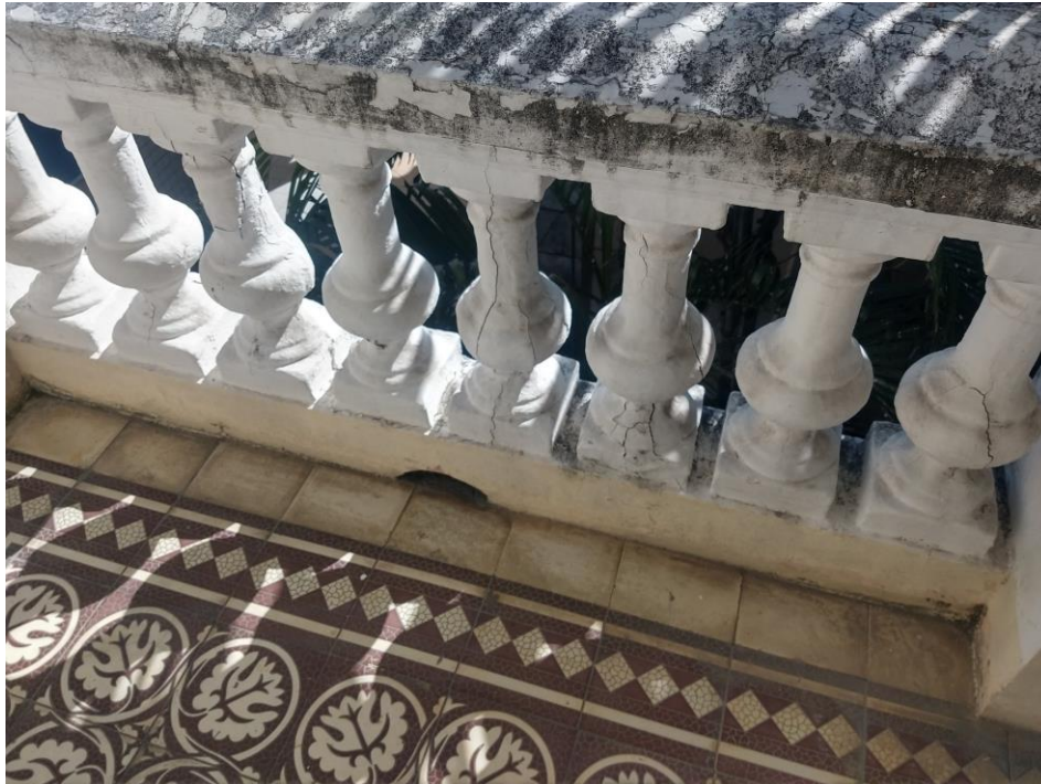
Figura 13 – Fissuras nos guarda corpos do 1º Pavimento
