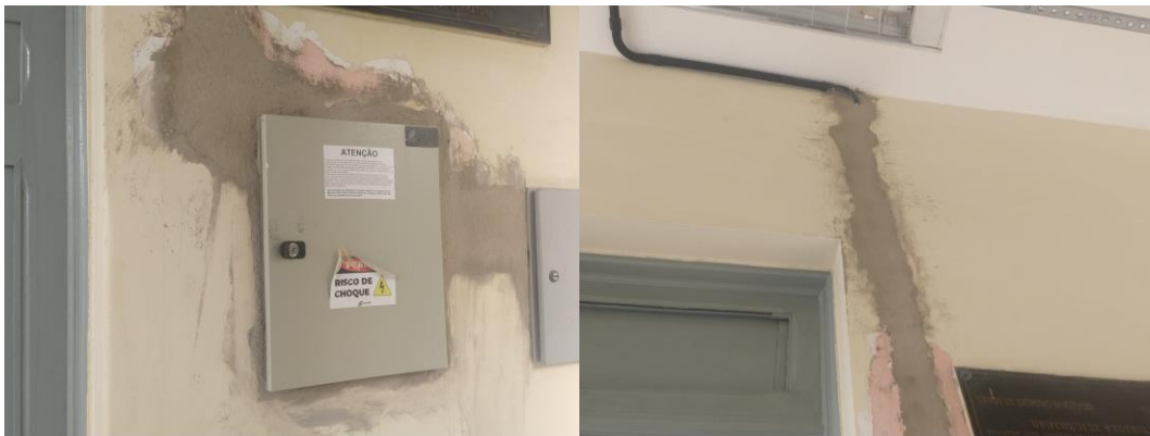
Figura 18 – Falta de acabamento na alvenaria do corredor do térreo
