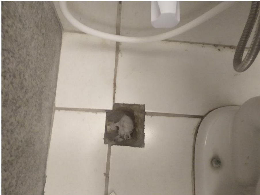
Figura 37 – Falta de ralo no banheiro feminino
