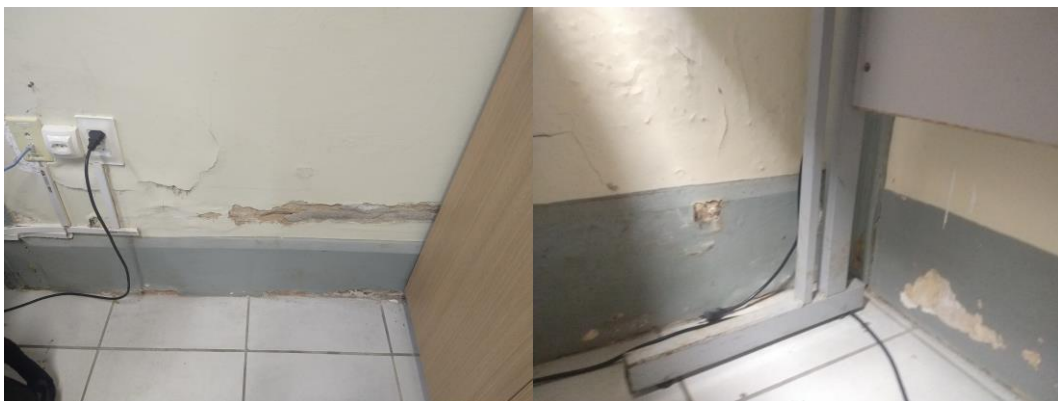
Figura 17 – Pontos de patologias em pintura na área interna da edificação
