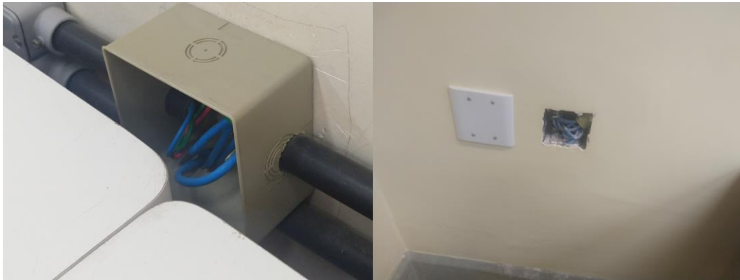
Figura 35 – Caixas de luz sem acabamento e com fiação exposta
