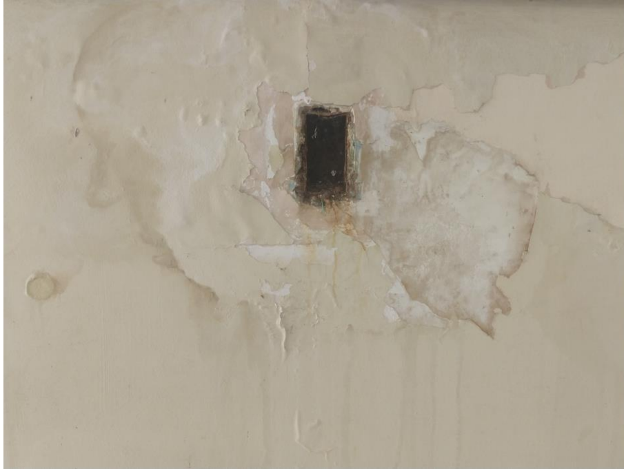
Figura 34 – Presença de caixa de luz sem acabamento
