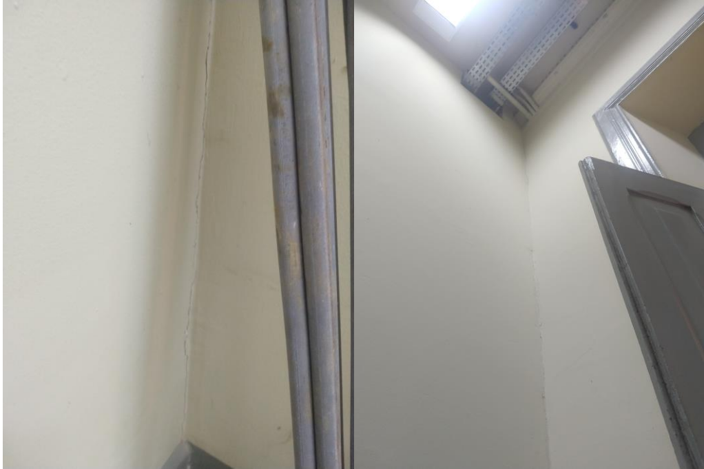
Figura 14 – Presença de fissuras verticais em alguns encontros de paredes
