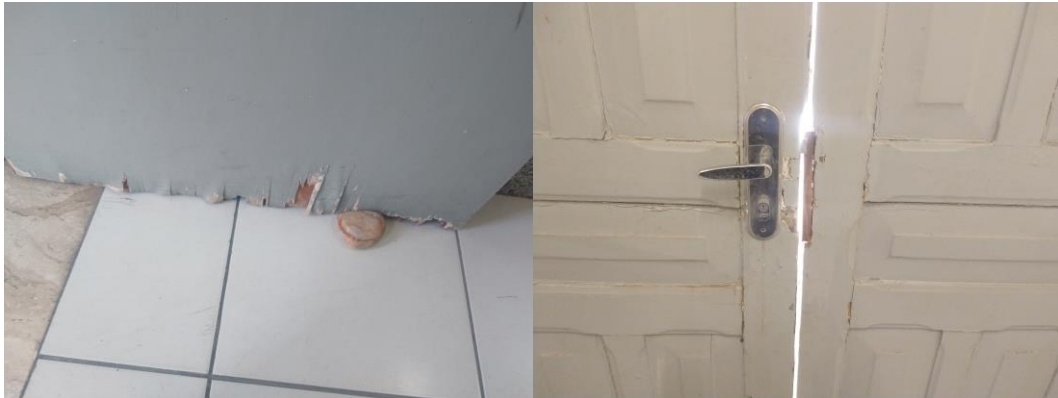
Figura 23 – Alto grau de deterioração em algumas portas da edificação
