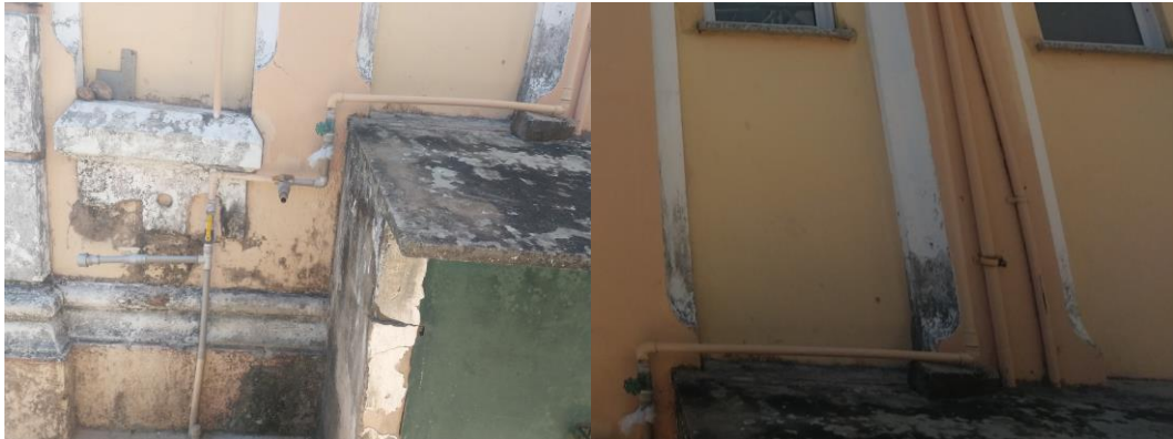
Figura 15 – Pontos de umidade nas paredes externas da edificação
