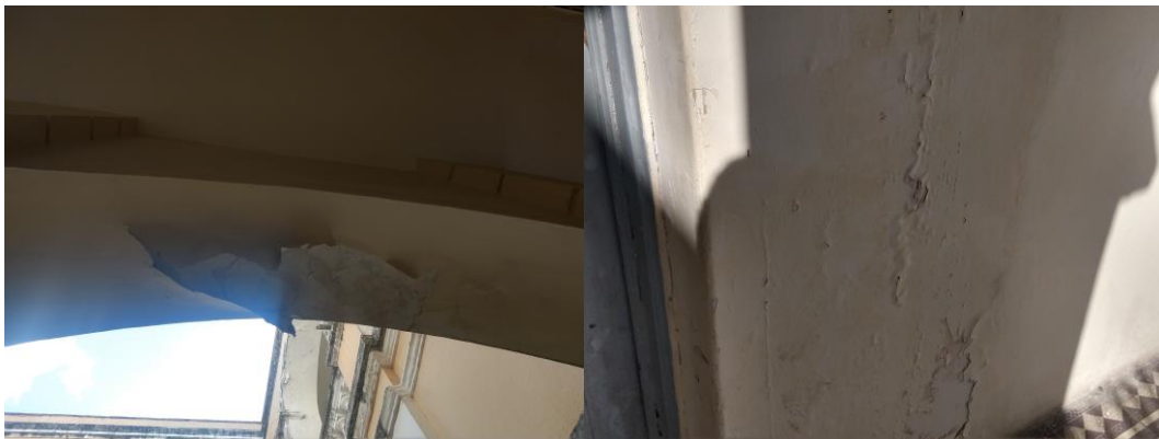
Figura 16 – Pontos de patologias em pintura na área externa da edificação
