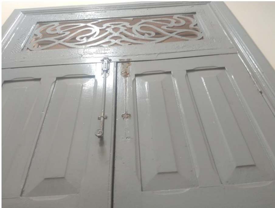
Figura 26 – Porta sem a presença de ferrolho para travamento
