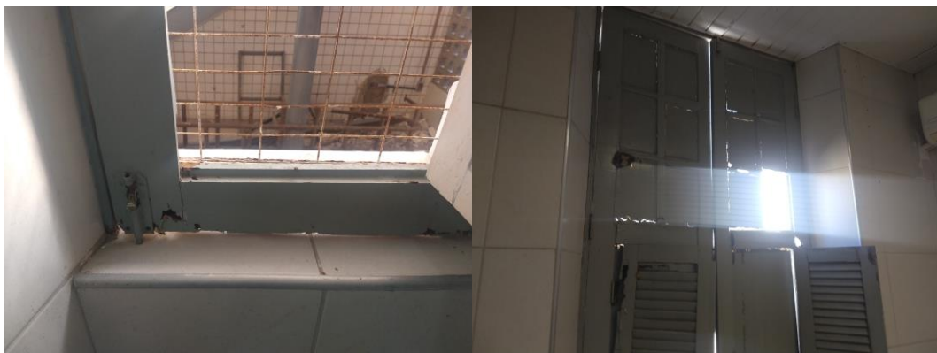
Figura 24 – Alto grau de deterioração em algumas janelas da edificação
