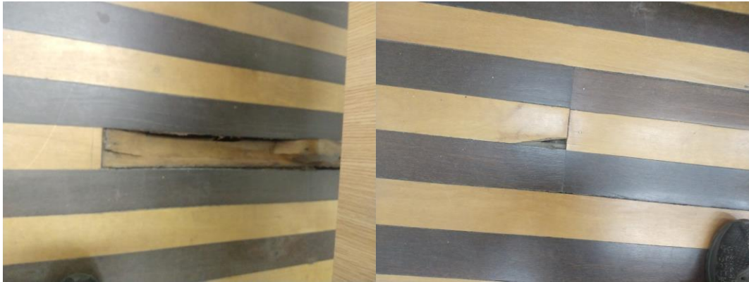
Figura 19 – Presença de buracos no piso de madeira
