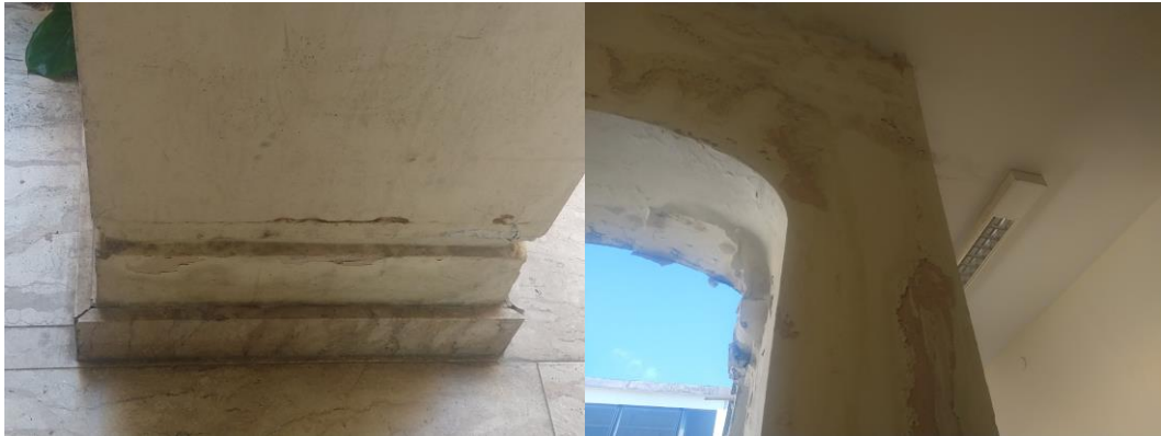
Figura 11 – Presença de pontos de umidade nas bases e topos de pilares
