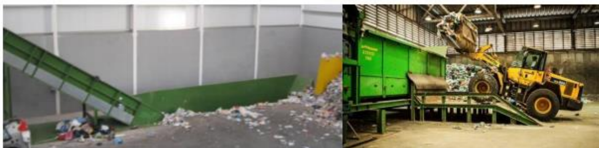
Figura 26 – Alimentador primário enterrado (esquerda) e suspenso (direita).
