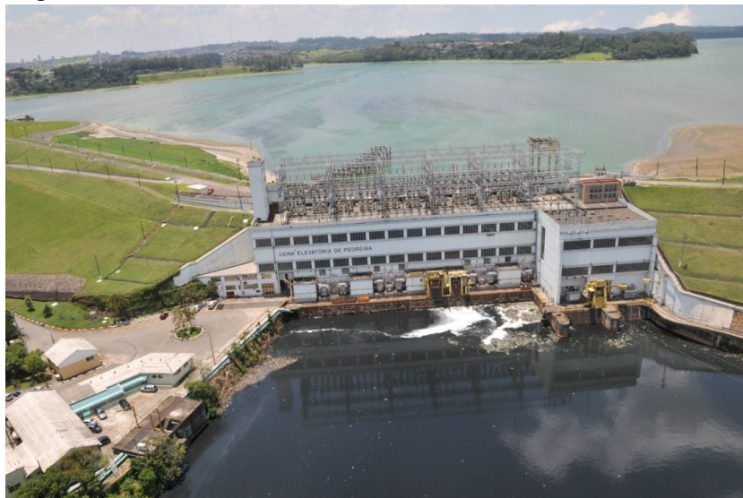
Figura 40 – Usina elevatória de Pedreira
