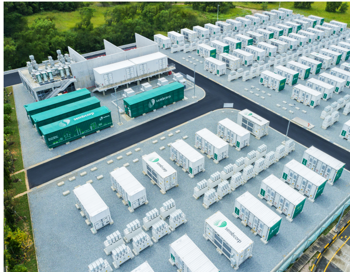
Figura 49 – BESS 285 MWh Semdcorp em Singapura
