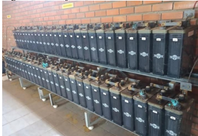
Figura 16 - Conjunto de baterias
