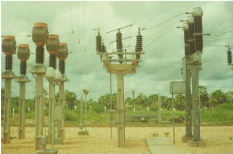
Figura 5 - Chave Seccionadora de 69 KV
