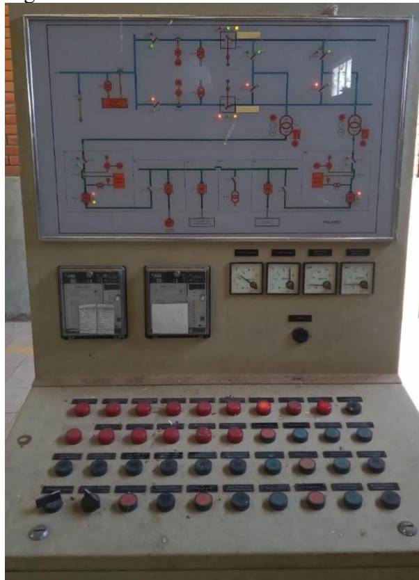
Figura 12 - Mesa de comando SE 69KV
