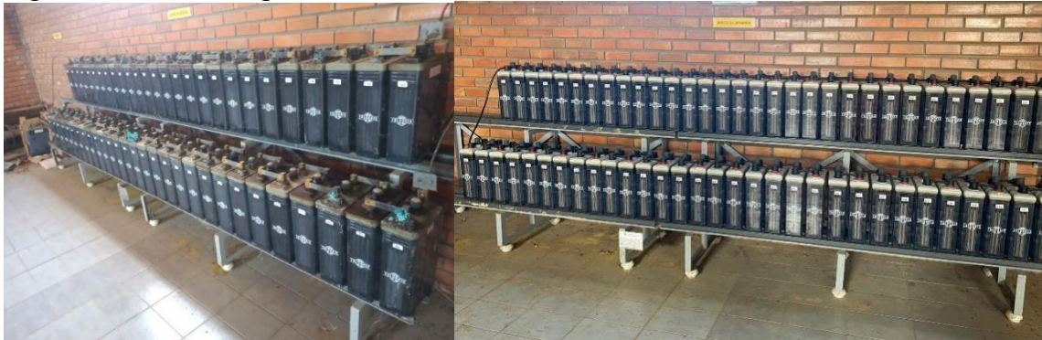
Figura 33 - Antes e depois do banco de baterias
