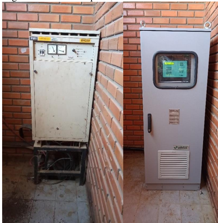
Figura 34 - Antes e depois do retificador das baterias
