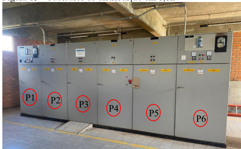
Figura 15 - Cubículos de distribuição em 6,6kV
