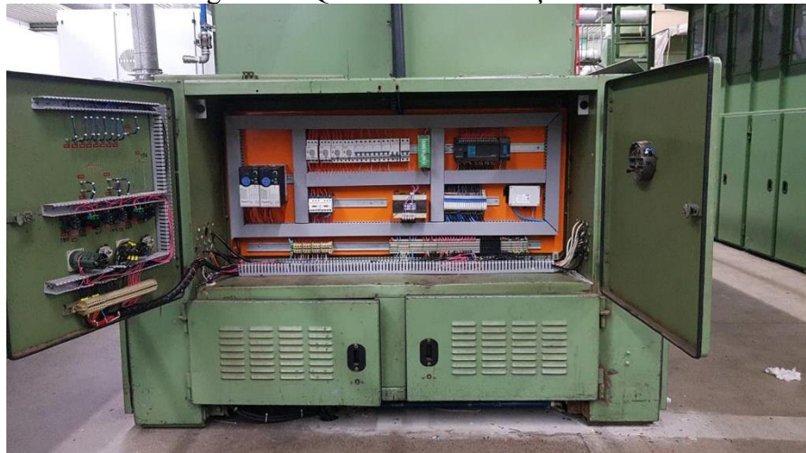
Figura 8 – Quadro de distribuição novo
