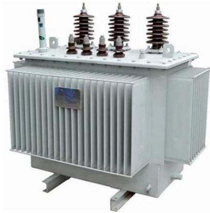
Figura 10 – Transformador de distribuição de 500kVA
