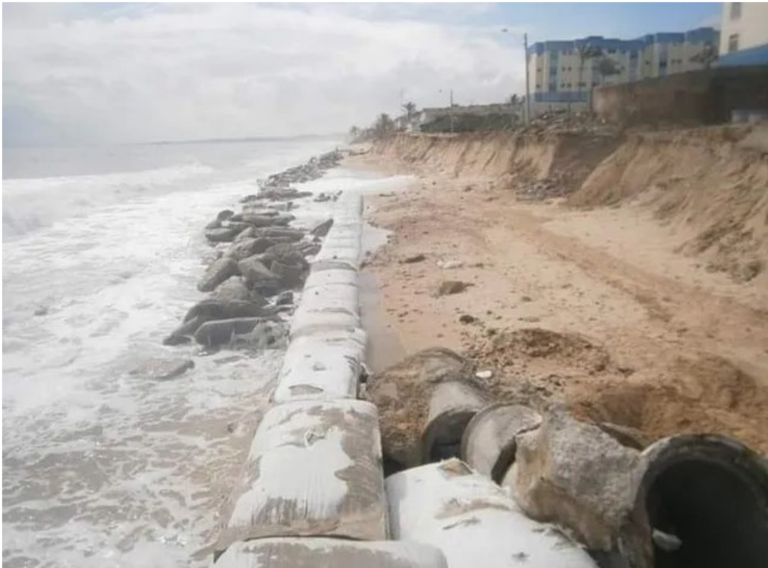
Figura 7 - Resíduos do bagwall na faixa de areia da praia do Icaraí.
