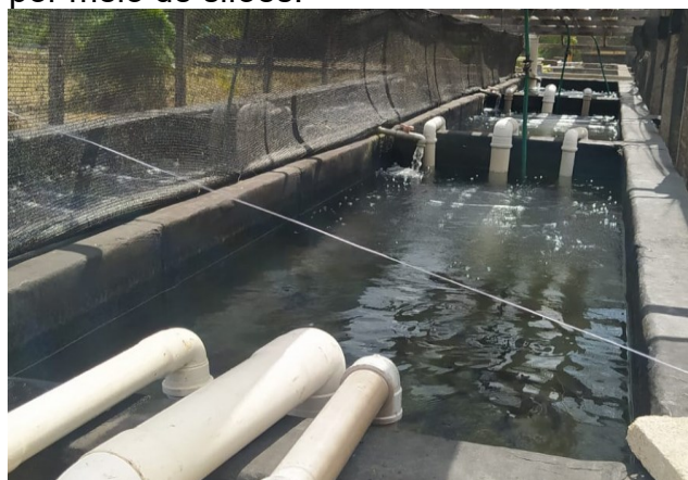
Figura 4 - Tanques retangulares de alvenaria revestidos com manta asfáltica e interligados por meio de sifões.
