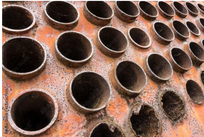
Figura 6: Corrosão em caldeira
