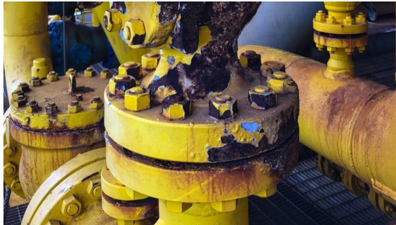
Figura 4: Corrosão por frestas
