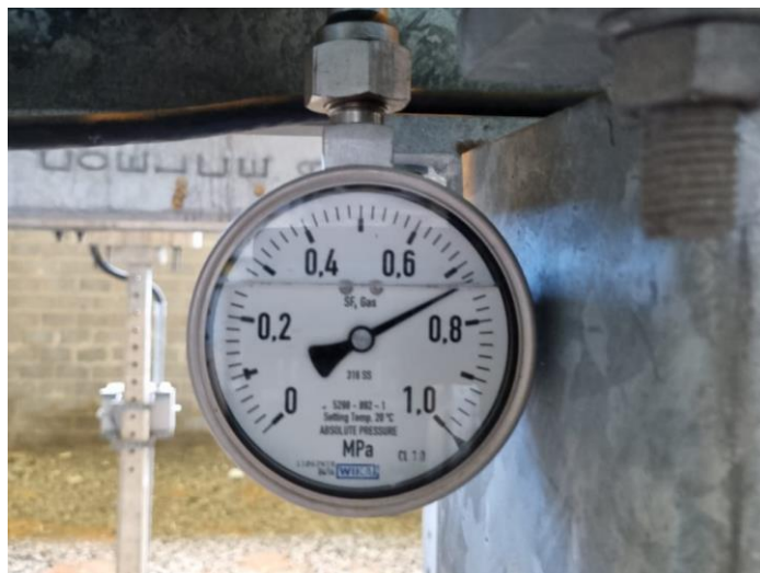
Figura 19 – Indicador do nível de gás do disjuntor da SE estudada
