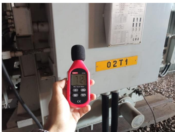
Figura 20 – Medição do nível de ruído próximo ao transformador
