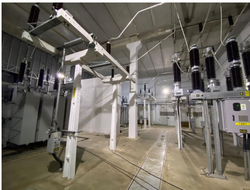
Figura 8 – Subestação de 69 kV abrigada
