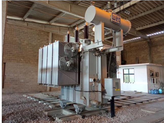
Figura 15 – Transformador 69/13,8 kV de 20 MVA instalado na SE estudada
