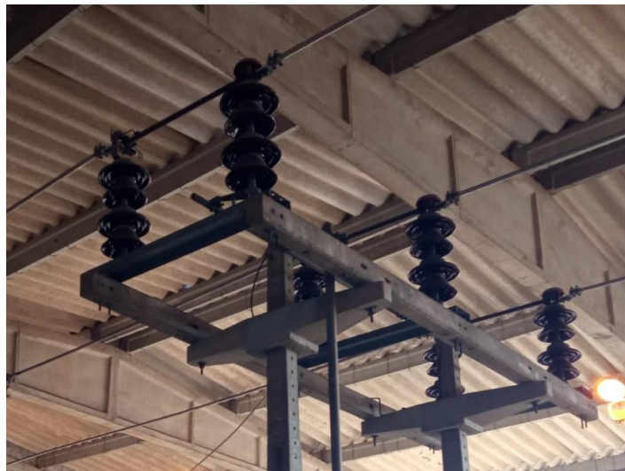
Figura 14 – Chave seccionadora do barramento de transição instalada na SE estudada
