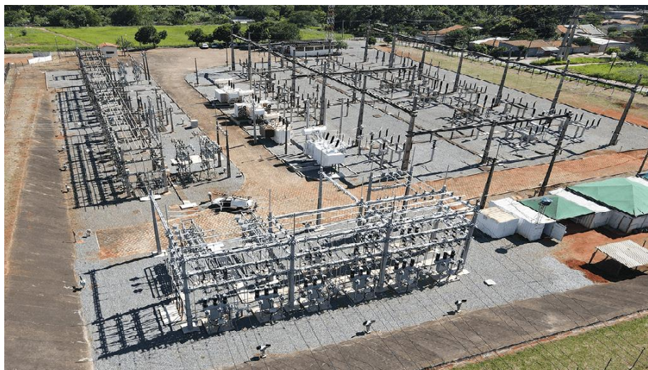
Figura 7 – Subestação Independência, em Aparecida de Goiânia, GO
