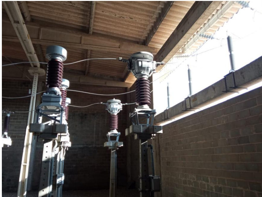
Figura 12 – Conjunto de medição da Enel e para-raios instalados na SE estudada
