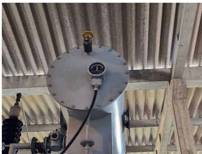
Figura 18 – Indicador do nível de óleo do transformador da SE estudada
