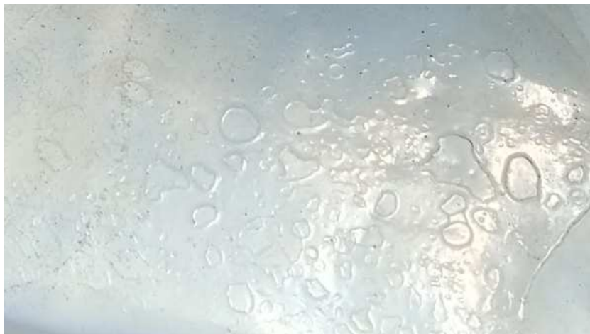
Figura 52 - Manchas na Superfície Pintada.
