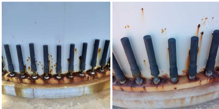
Figura 20 - Oxidação encontrada na Base da Torre.
