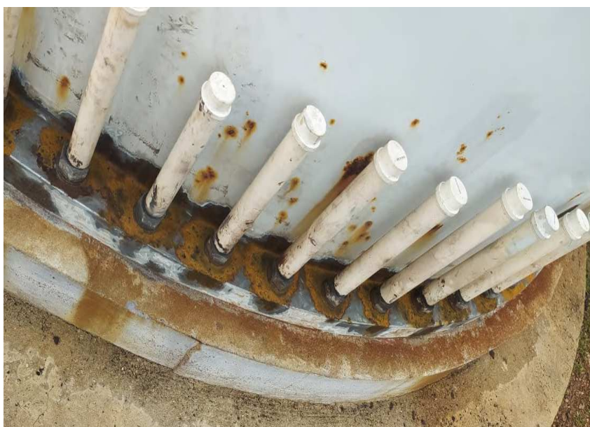
Figura 47 - Base Oxidada Devido a Chuva
