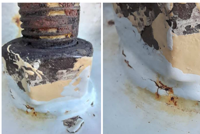
Figura 59 - Retorno de Oxidação em Volta das Arruelas.
