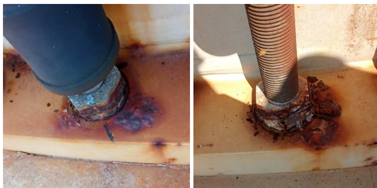
Figura 22 - Estado Inicial em Volta do Parafuso.
