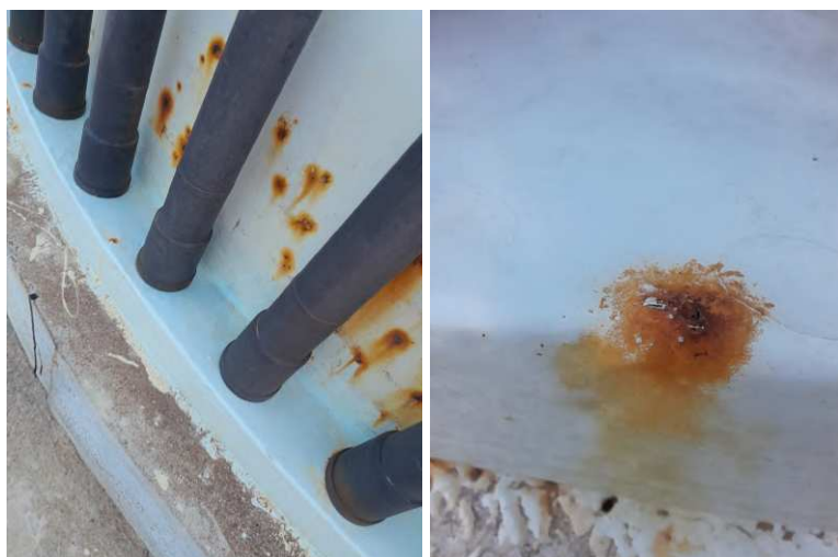
Figura 57 - Ponto de Oxidação na Base.
