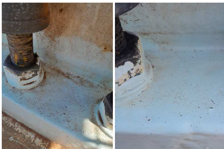
Figura 61 - Aumento da Oxidação
