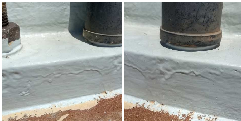
Figura 51 - Escorrimento de Tinta.
