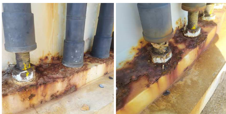
Figura 23 - Estado de Corrosão Inicial da Base.
