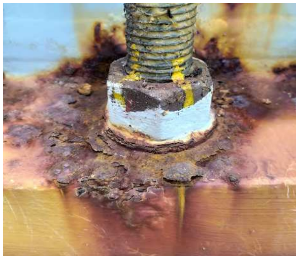
Figura 24 - Corrosão Inicial Arruela.
