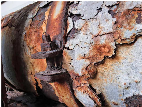
Figura 10 - Corrosão por Placas
