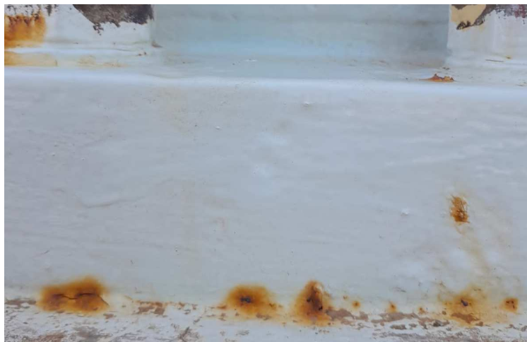
Figura 58 - Pontos de Oxidação na Lateral da Base.
