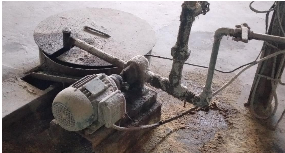
Figura 10 – Vazamento de óleo no chão de estabelecimentos visitados durante o período de estágio
