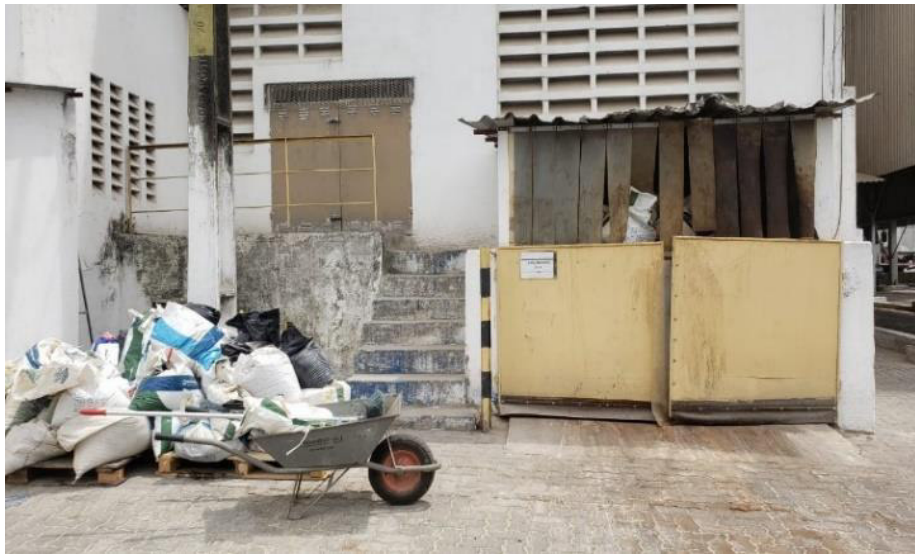
Figura 12 – Acúmulo de lixo na área externa do estabelecimento produtor de ração visitado durante o período de estágio
