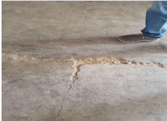
Figura 8 – Danos nos pisos da área de armazenamento de matéria prima de estabelecimentos visitados durante o período de estágio
