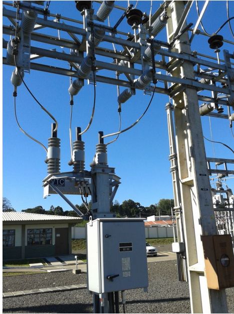
Figura 6 – Religador automático instalado em uma subestação.
