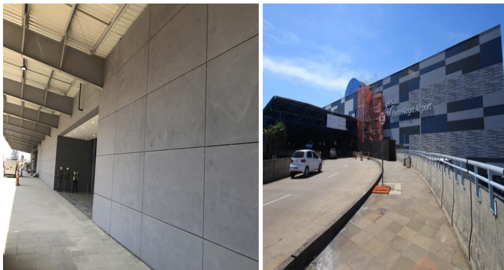
Figura 48 - Aeroporto Salgado Filho - Revestimento de Fibrocimento.
