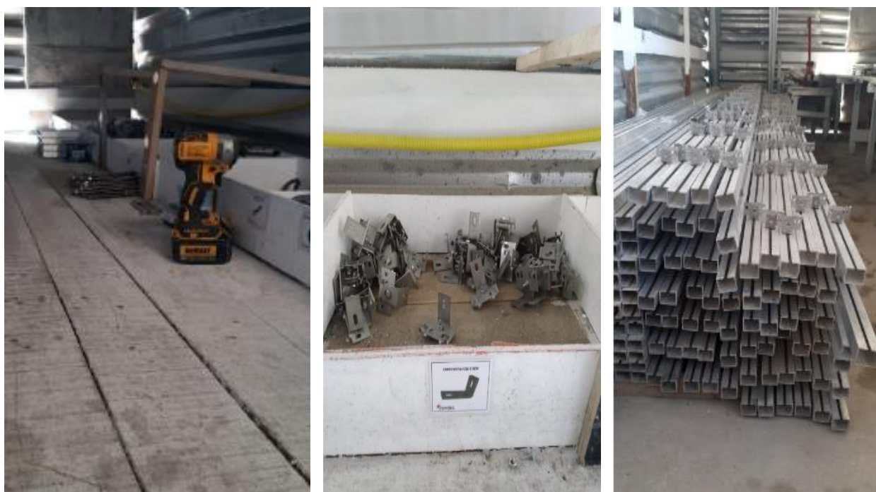
Figura 65 - Central de montagem dos perfis
