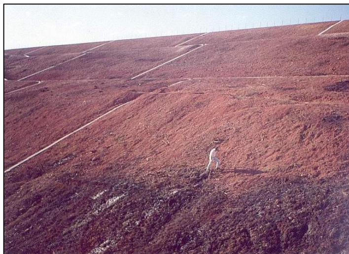
Figura 19 - Ressurgência no talude de jusante
