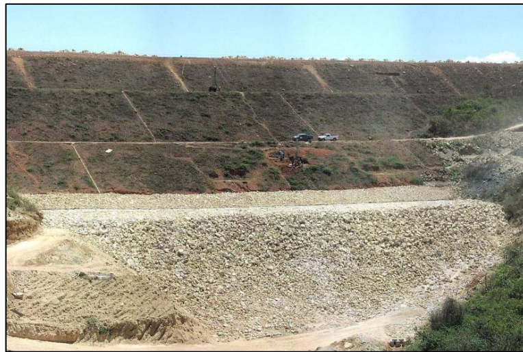
Figura 20 - Dreno de pé da barragem
