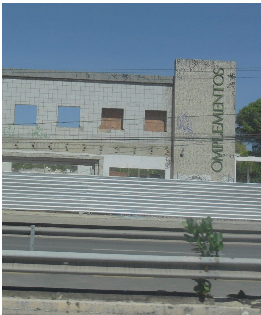
Figura 18 - Edifício em ruínas.
