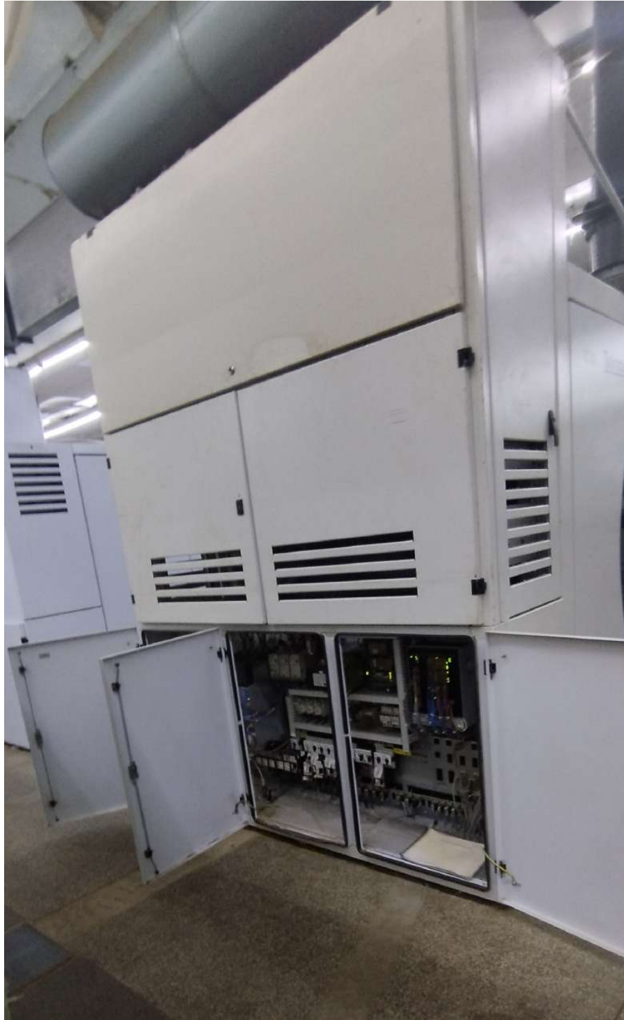
Figura 22 – Painel elétrico da carda onde foi instalado o dispositivo analisador
