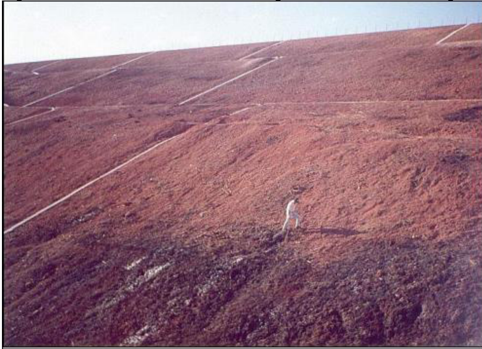
Figura 2 — Talude de Jusante da barragem Jaburú I com ressurgência.
