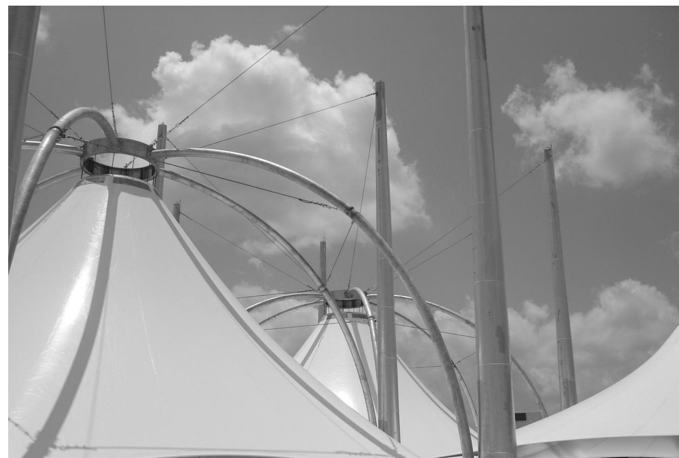
Figura 27: Módulos tipo tenda cônica da Feira da Cidade em Ananindeua Fonte: Archidaily
