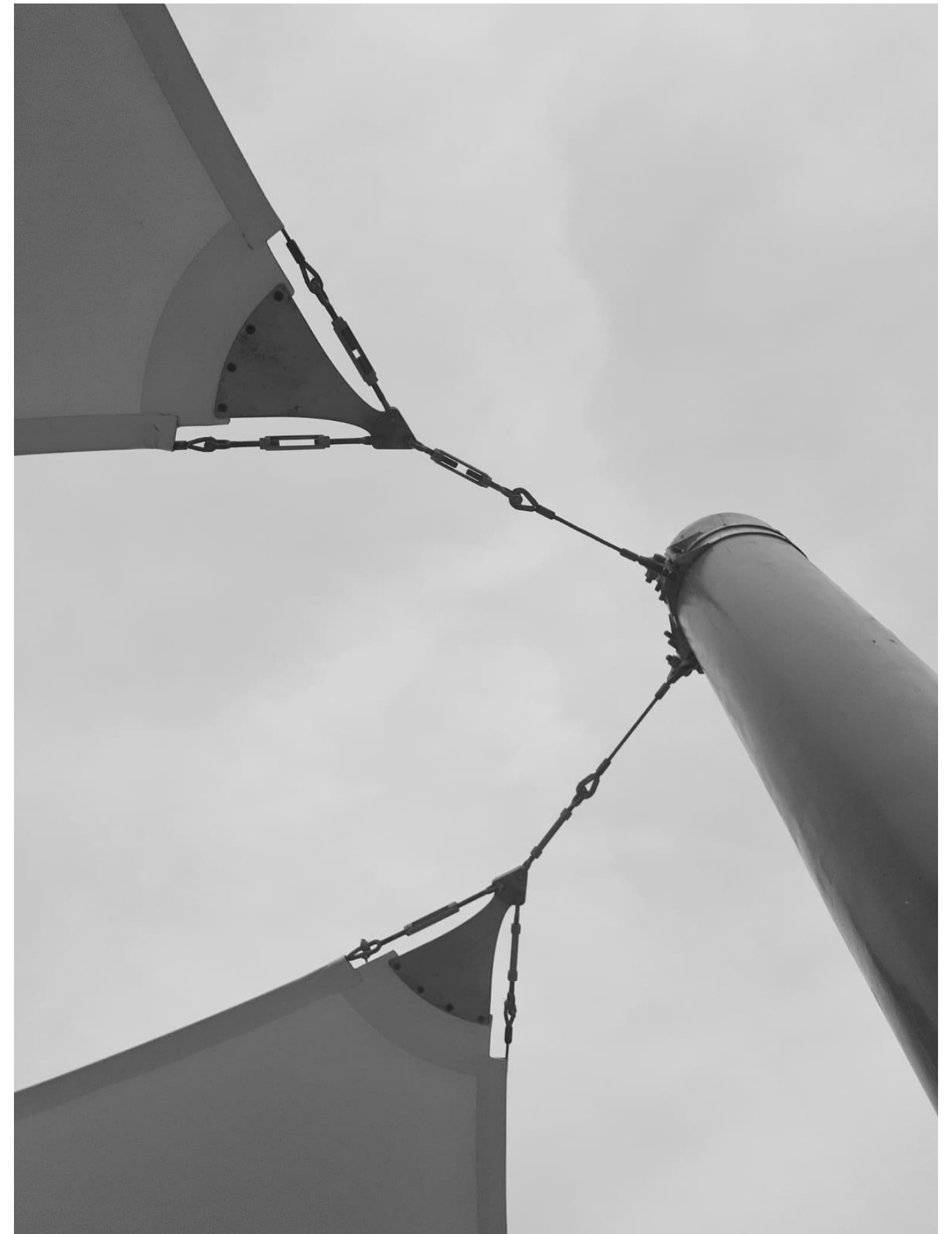
Figura 33: Fixação de coberta tensionada da Feirinha da Beira Mar Fonte: Acervo pessoal
