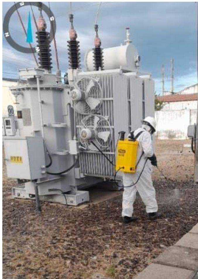
Figura 4: Aplicação de herbicidas por pulverização em uma subestação de distribuição.
