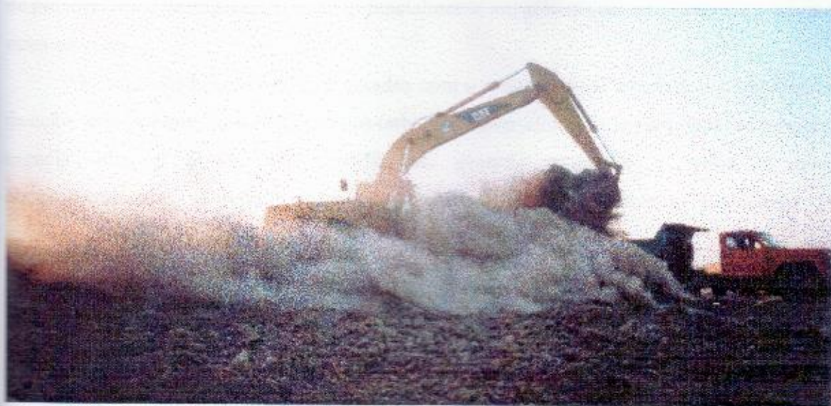
Figura 22 – Poeira decorrente da construção dos viveiros e canais. Classificação do impacto ambiental (-DPI) / Quanto ao CARATER é ADVERSO ; quanto a ORDEM, DIRETA ; quanto a MAGNITUDE, PEQUENA e quanto a DURAÇÃO, CURTA .
