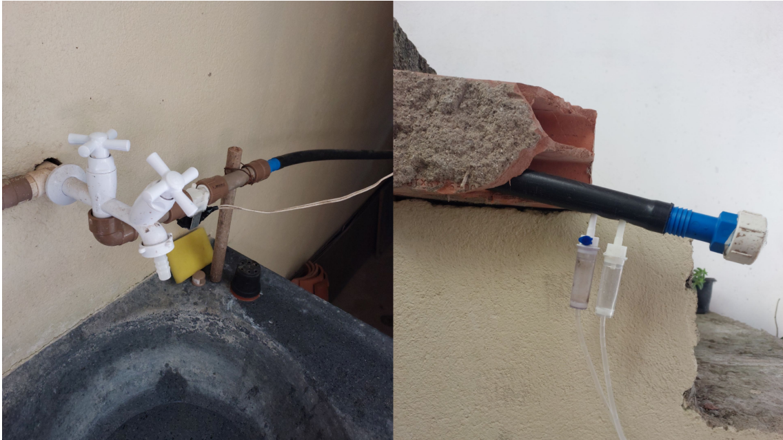
Figura 12 – Foto do sistema hidráulico
