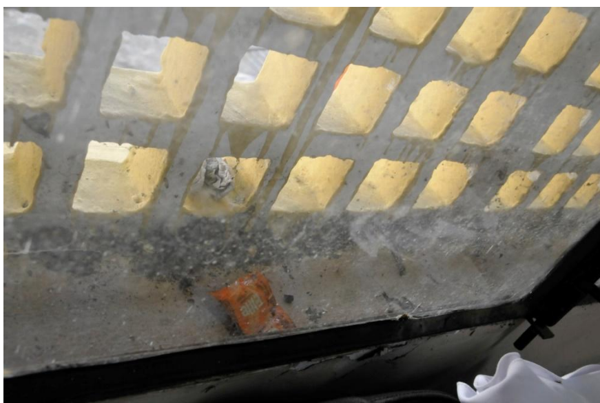
FOTO 9 – Presença de cobogós e acúmulo de poeira
