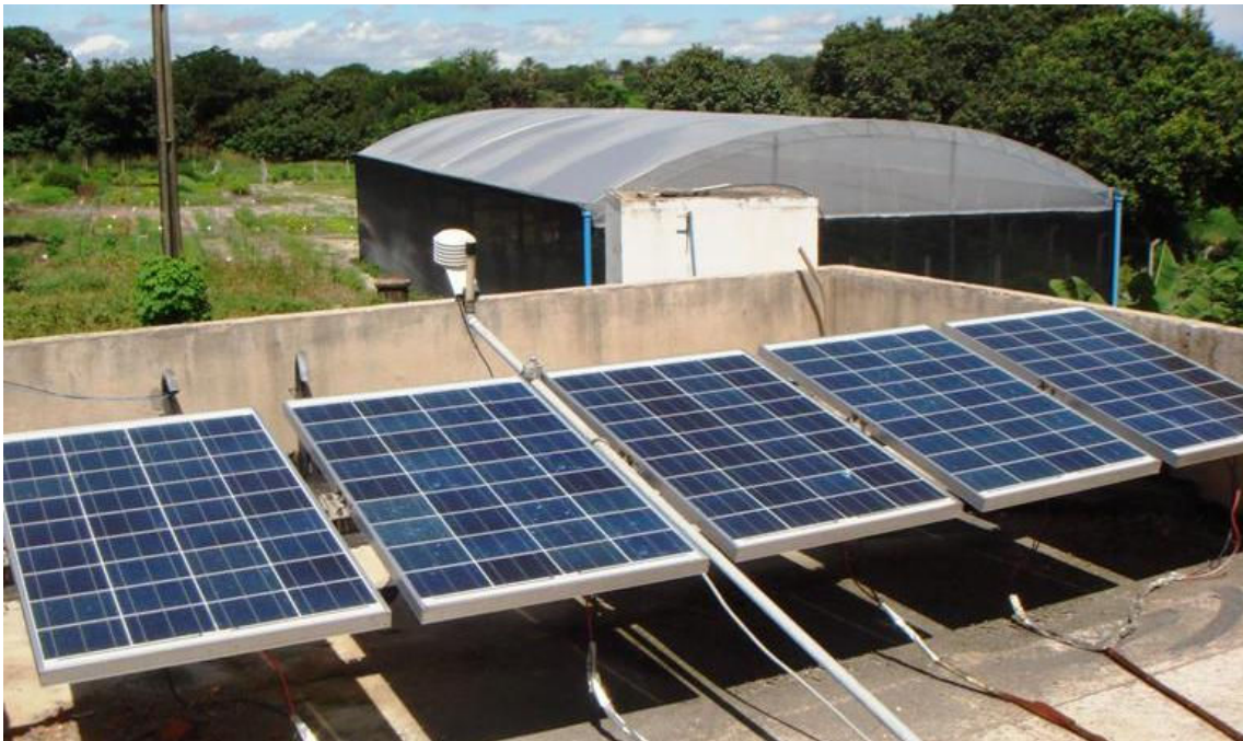
Figura 4 – Painéis fotovoltaicos do LEA - UFC
