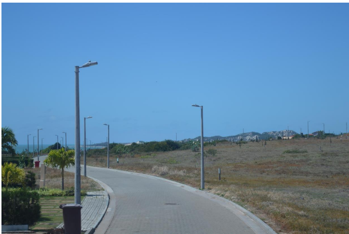
Figura 21 – Via Interna do CTI Aquiraz Riviera com rede de iluminação elétrica
