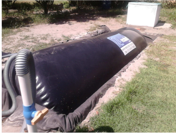
Figura 3 - Biodigestor do LEA.
