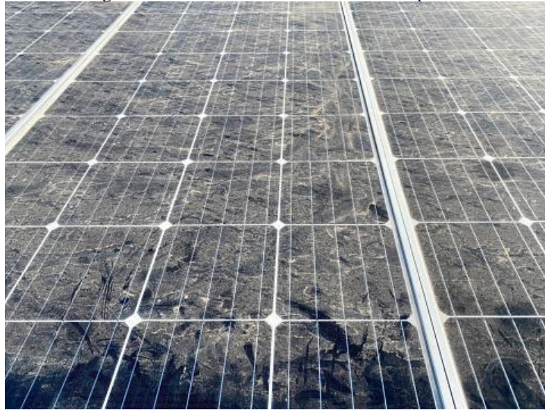
Figura 9 – Painéis fotovoltaicos cobertos de poeira.
