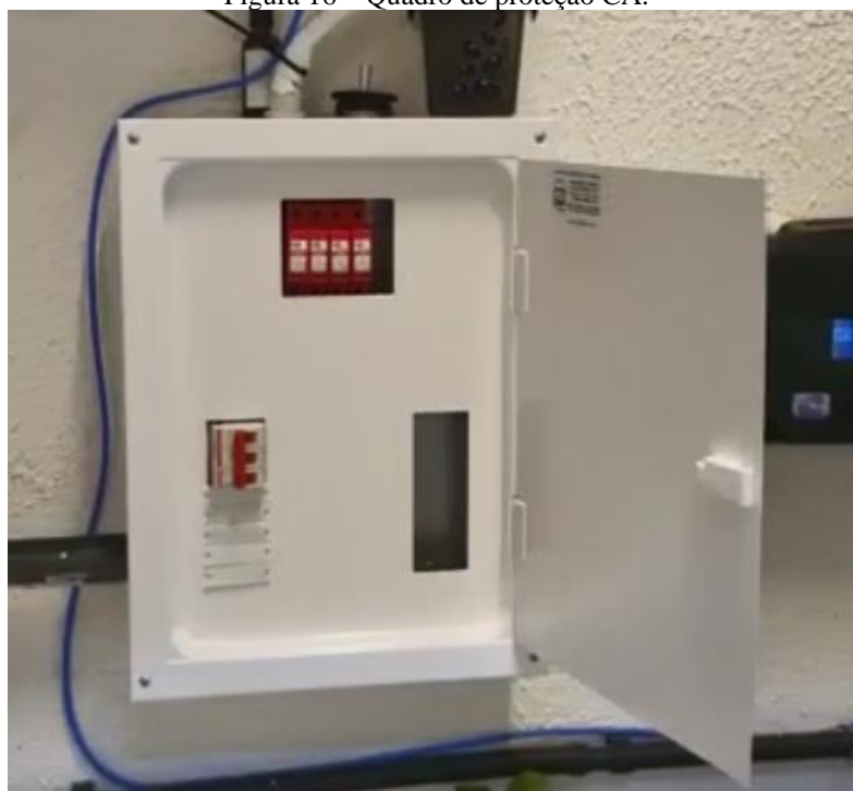
Figura 16 – Quadro de proteção CA.
