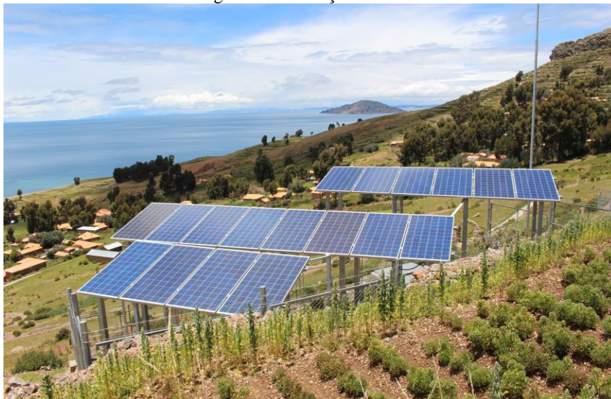
Figura 7 – instalação em solo.
