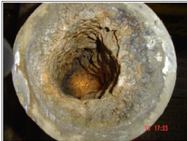
Figura 21. Tubulação com incrustação BaSO_4
