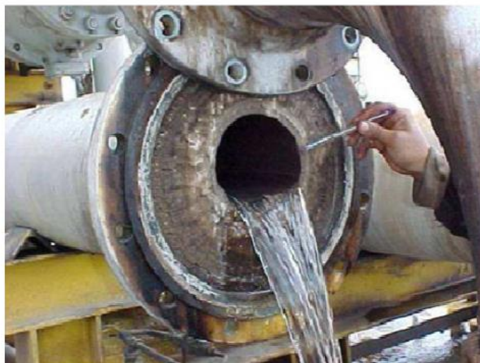
Figura 1. Incrustação em tubulação de descarte de água.
