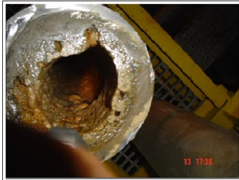
Figura 20. Tubulação com incrustação de BaSO_4 .
