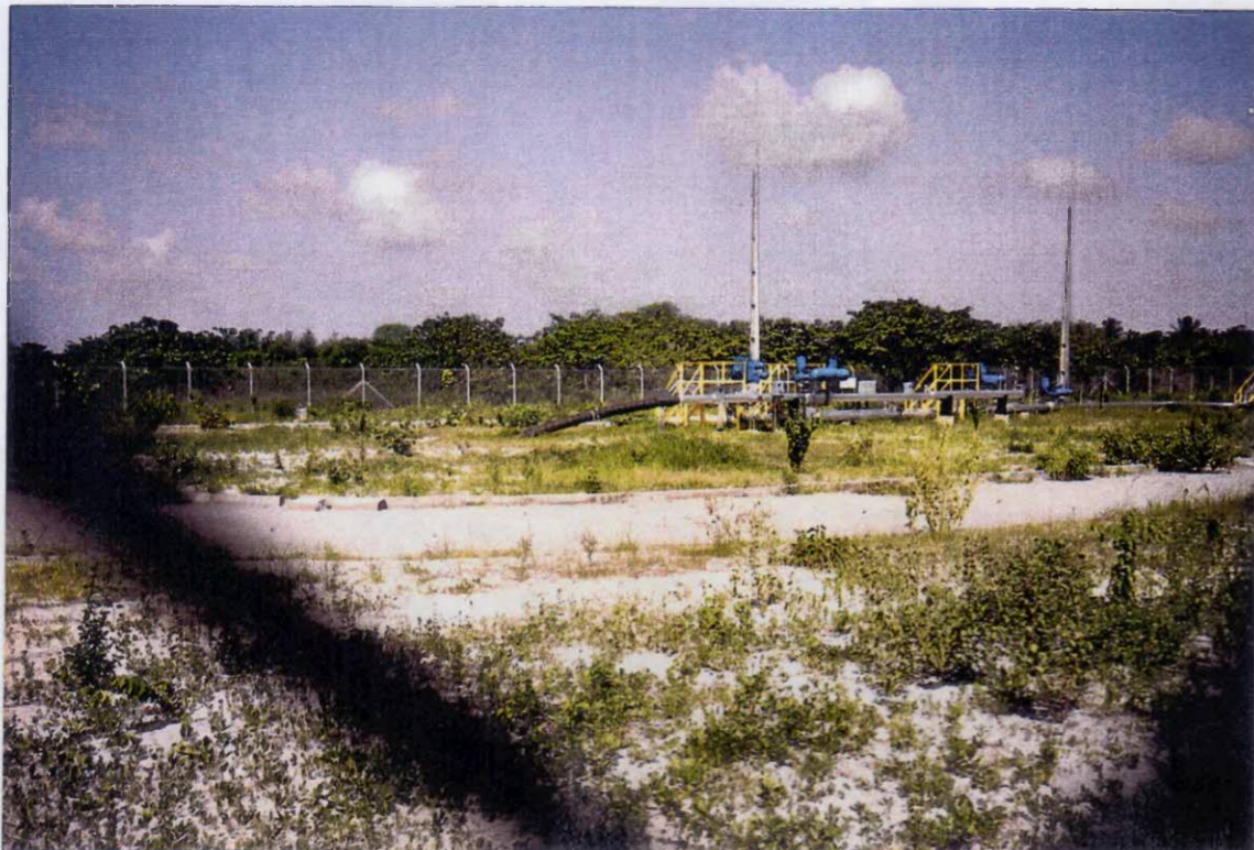
FOTO 8 - GASFOR. Gasoduto Guamaré – Fortaleza. Detalhe de uma unidade de controle. Aquiraz, 1999.
