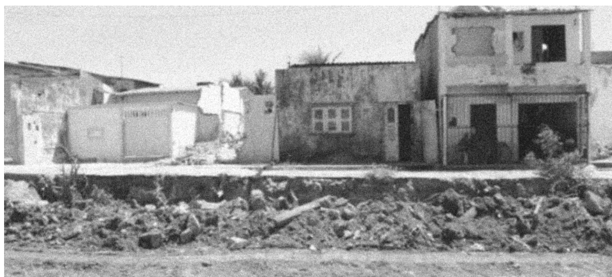
Figura 41: Obras deixam entulho e danos colaterais nas edificações que permaneceram.
