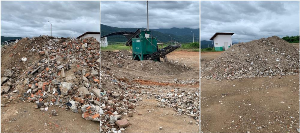
Figura 12- Unidade de tratamento de resíduos da construção civil localizada na central de resíduos de Sobral
