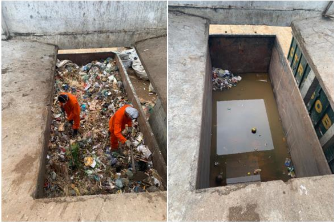
Figura 14- Caçambas da estação de transbordo de Forquilha
