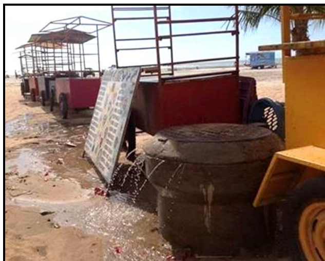
Figura 17 – Estação elevatória com vazamento de esgoto diretamente na rua
