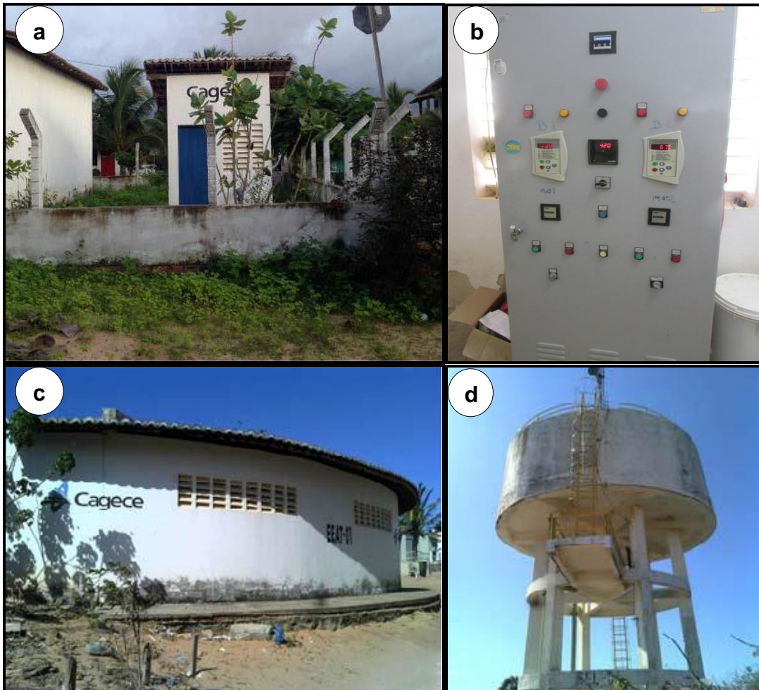
Figura 12 – Sistema de abastecimento de água na Vila de Jericoacoara: (a) poço de captação da CAGECE, (b) central de controle, (c) Estação Elevatória de Água, (d) Reservatório elevado
