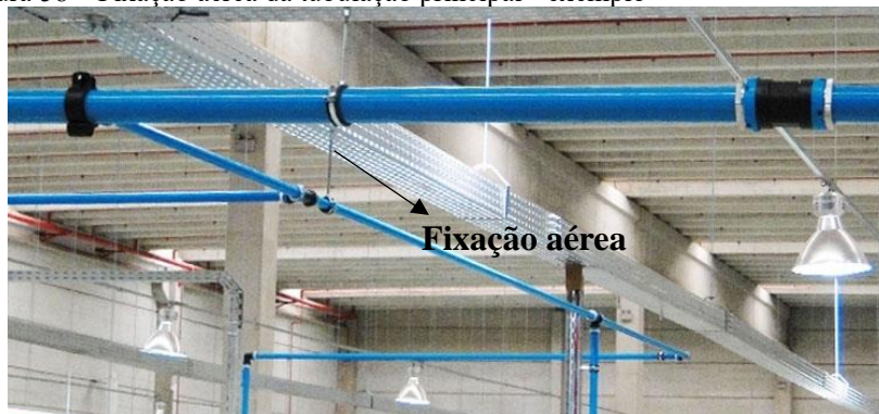
Figura 58 – Fixação aérea da tubulação principal - exemplo
