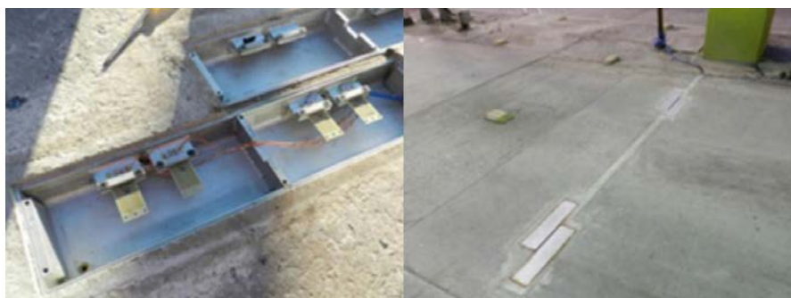
Figura 2 - Sensores piezoelétricos instalados na praça de pedágio
