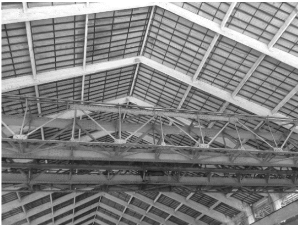
Figura 2.29 – Coberta da oficina de reparação de carros e vagões, foto de 2017. Fonte: Acervo da autora.
