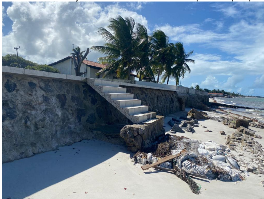
Figura 55 -Restos de construções e rochas do enrocamento espalhados pela praia.
