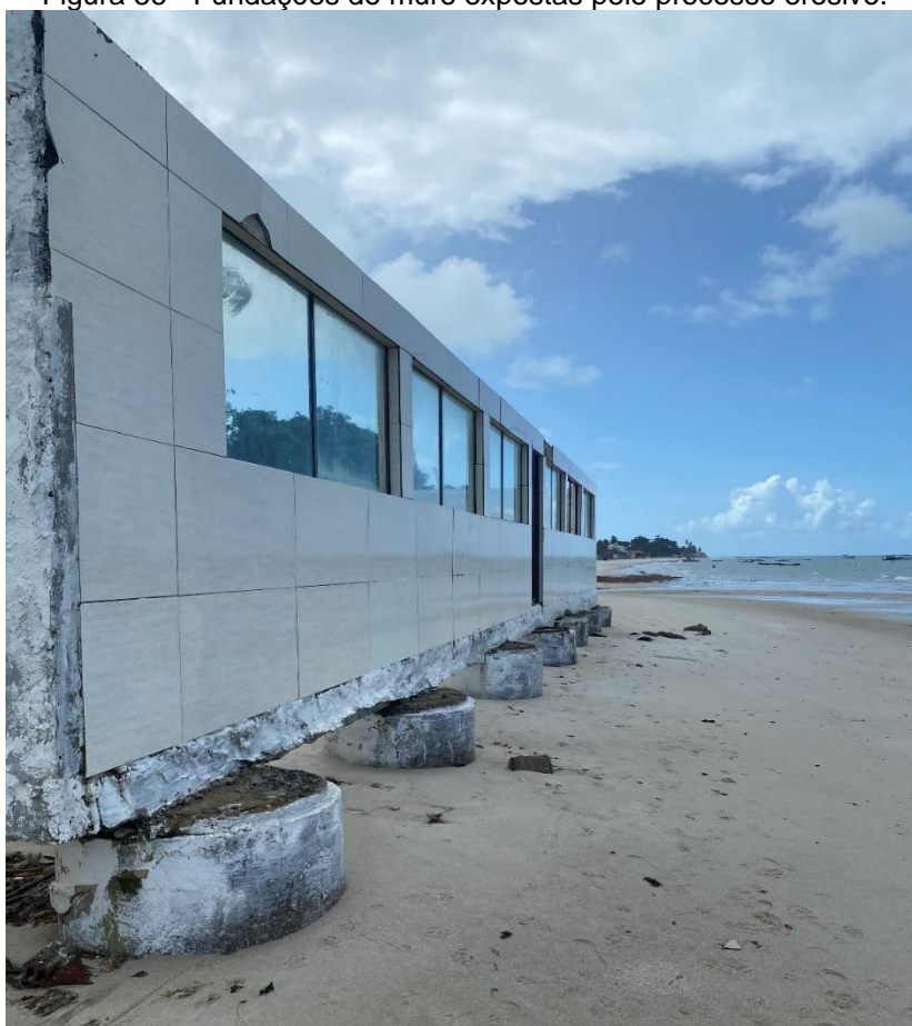
Figura 56 - Fundações do muro expostas pelo processo erosivo.
