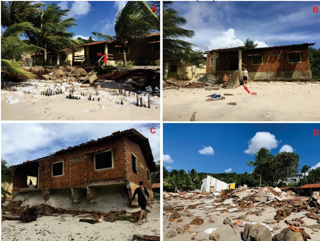
Figura 19 - Resultado do processo erosivo no perfil P1. (A) – Localização do nível de referência (RN) em julho de 2017. (B) Situação do nível de referência em março de 2018. (C) Observa-se que a casa foi construída em cima da faixa de pós-praia e em maio de 2018.
