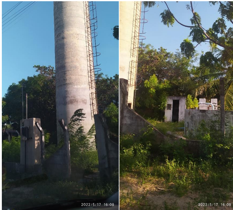
Figura 11 – Caixa d'água construída por meio do Projeto São José
