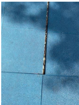
Figura 48 – Brechas entre placas emborrachadas da Brinquedopraça
