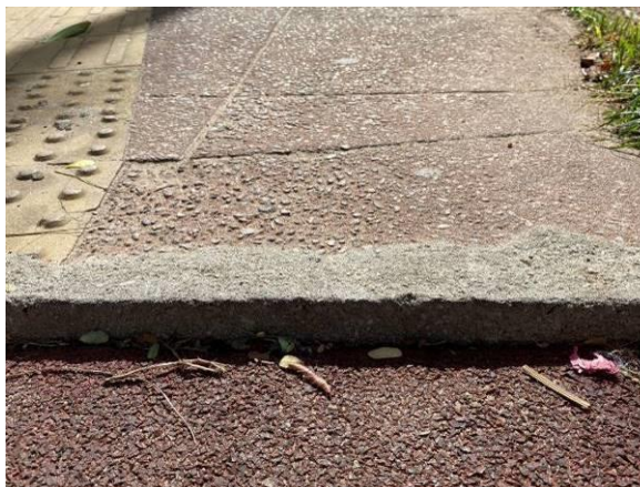
Figura 49 - Desnível existente no acesso à Brinquedopraça
