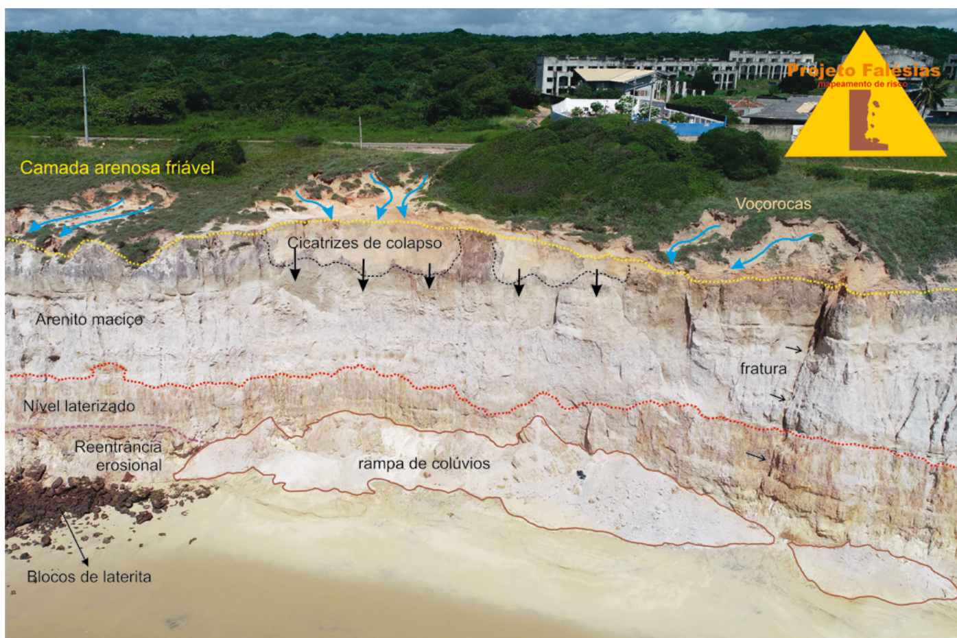
Figura 40 – Elementos e processos erosivos em Falésia de Barra de Tabatinga - RN
