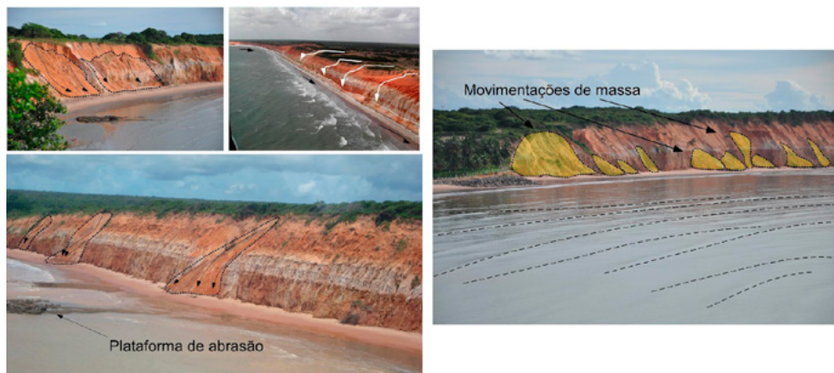
Figura 14 – Os movimentos de materiais (deslizamentos, desmoronamentos, desprendimentos de blocos e escorregamentos) e direção predominante das ondas que promovem a erosão do sopé da falésia e indução dos movimentos de massa
