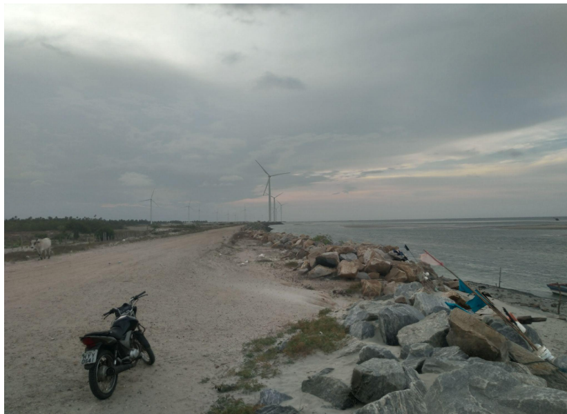
Figura 4 – Via de acesso construída pelo empreendimento em fase erosão acelerada.
