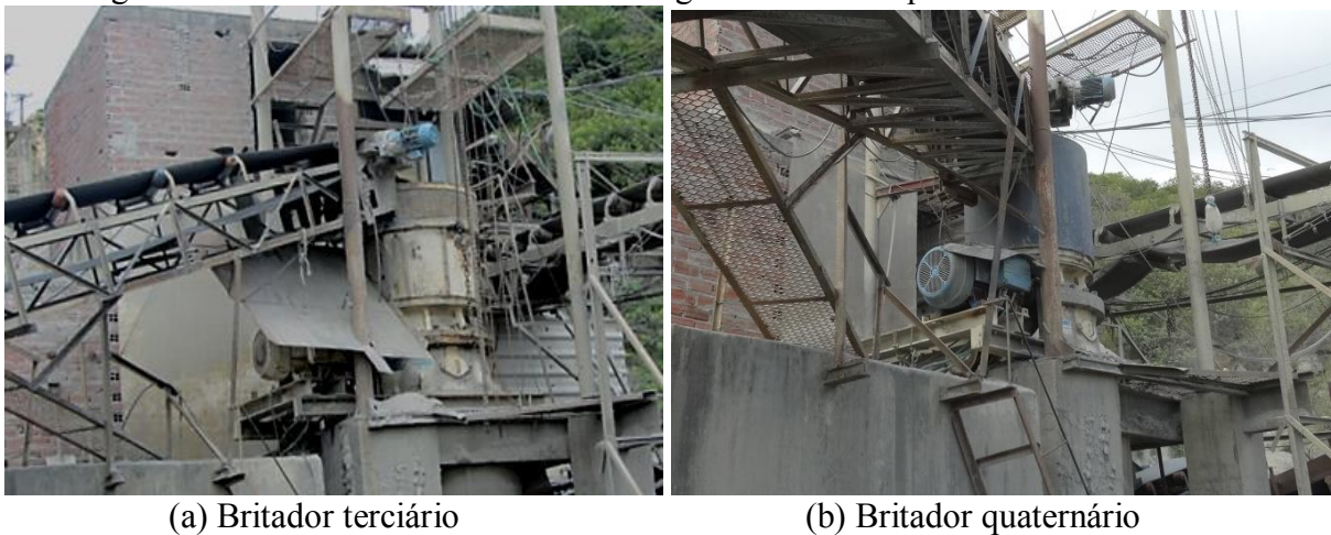
Figura 17 – Britadores utilizados nas britagens terciária e quaternária da Pedreira 3
