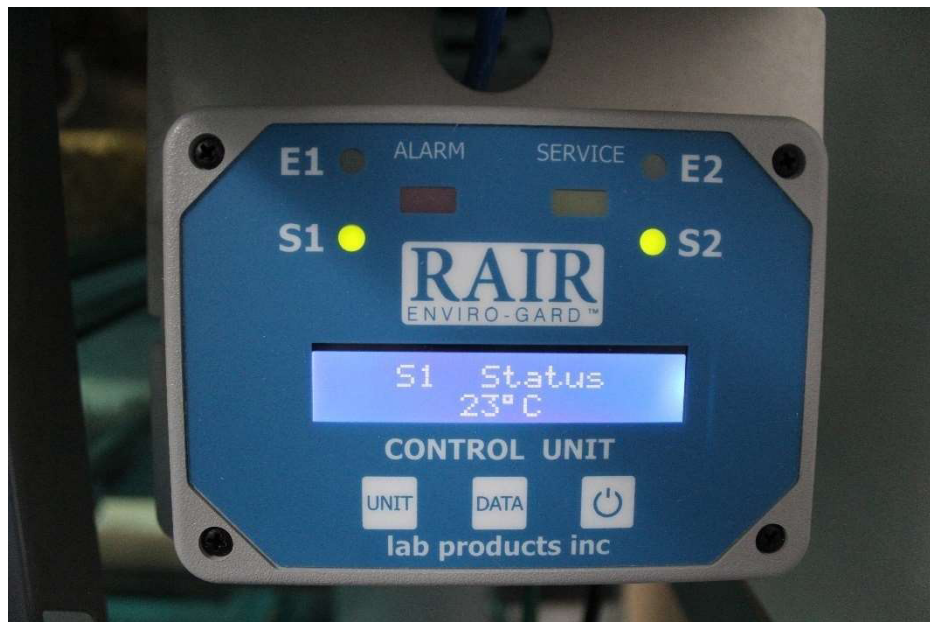
Figura 2 – Painel em led das racks ventiladas (Lab Products) utilizados para medição de temperatura e umidade.
