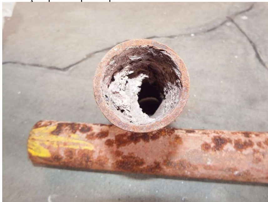
Figura 24 – Seção transversal de tubo com falha mostrando obstrução parcial por depósitos.
