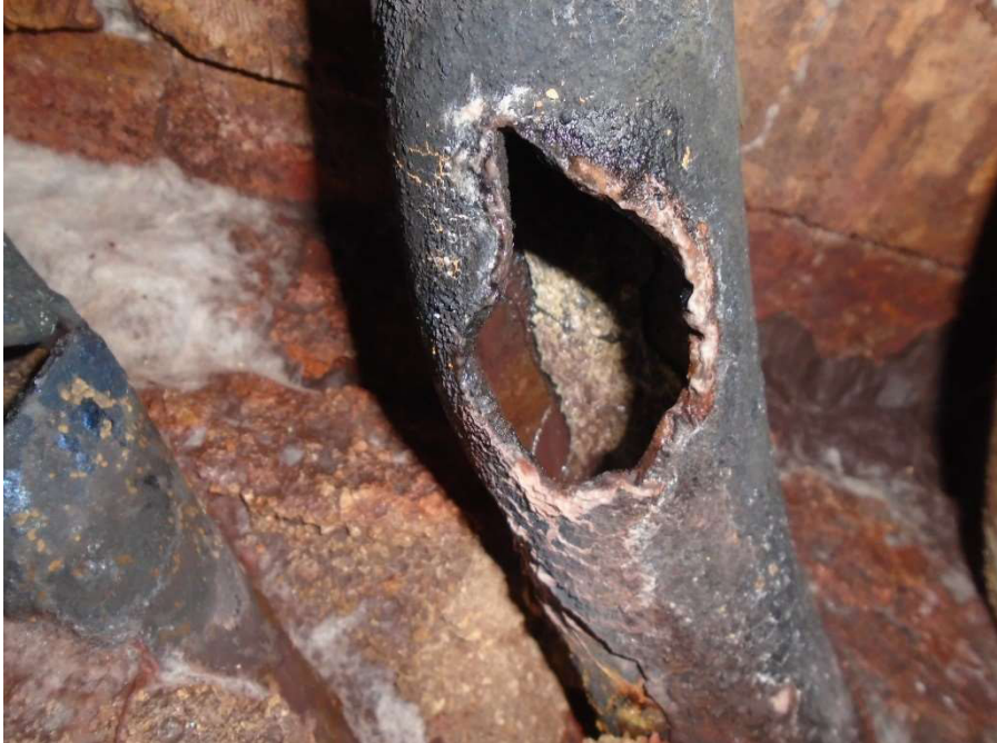
Figura 13 - Tubo da parede norte com formação de laranja e consequente fratura, com camada de óxido externamente.
