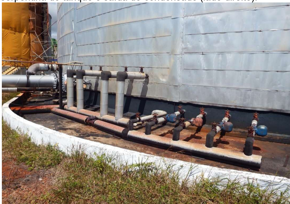
Figura 2 - Tubulações de entrada de vapor (lado esquerdo) para a serpentina do tanque e saída do condensado (lado direito).
