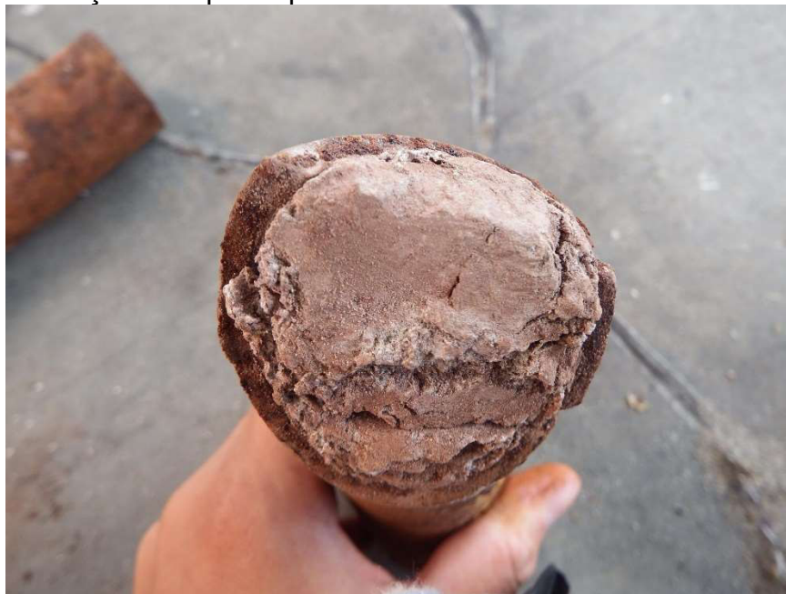
Figura 25 – Seção transversal de tubo com falha mostrando obstrução total por depósitos.
