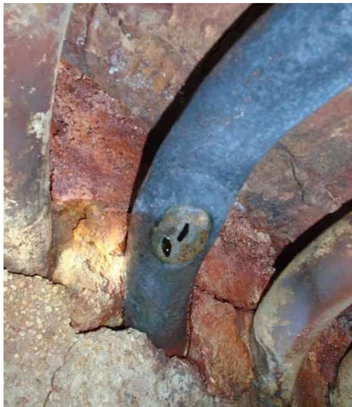
Figura 14 – Falha em tubo da parede norte com formação de laranja e camada superficial de óxido.
