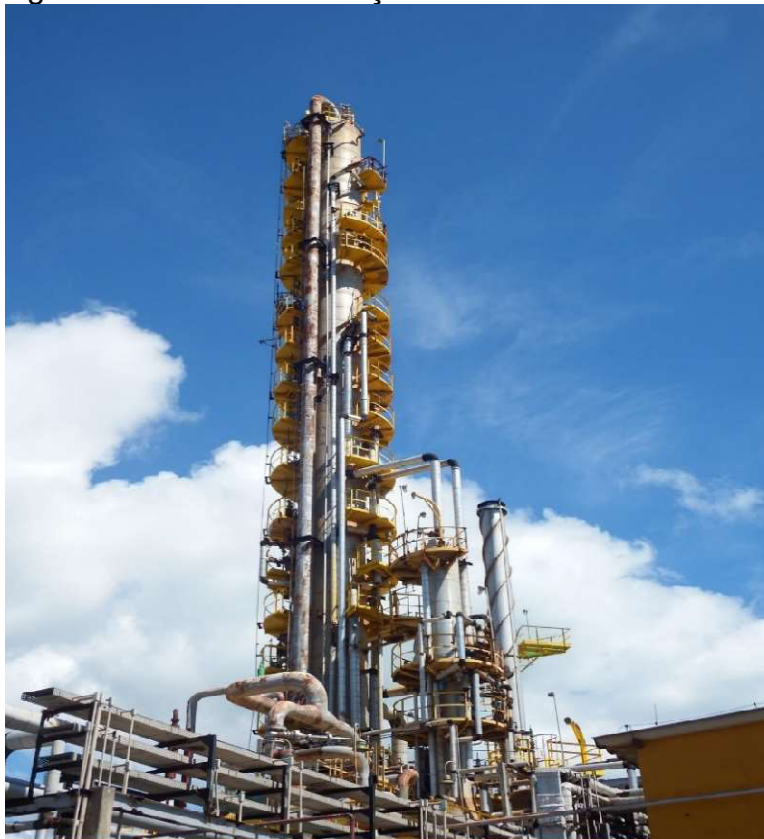
Figura 3 - Torre de destilação à vácuo.
