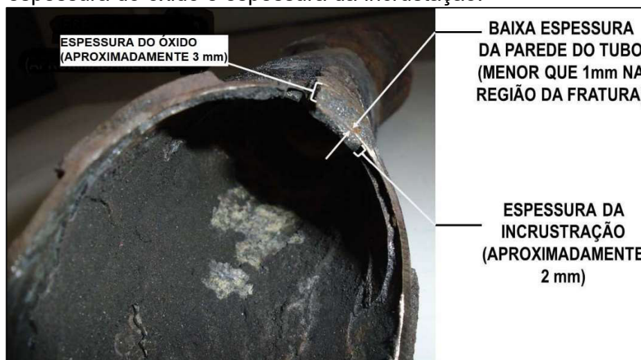
Figura 22 – Tubo rompido mostrando baixa espessura na parede, espessura do óxido e espessura da incrustação.
