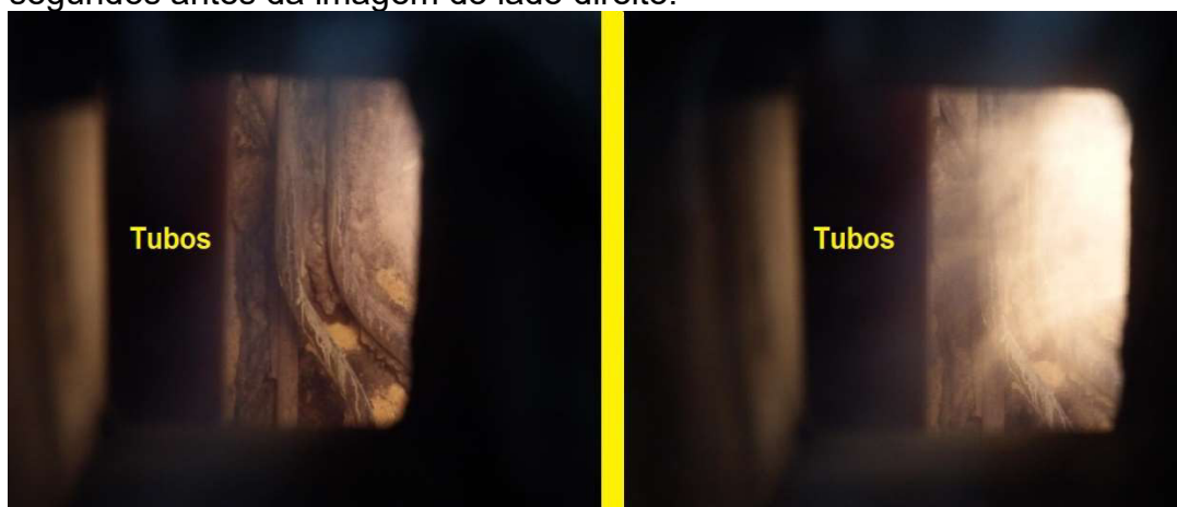
Figura 31 – Visor da fornalha mostrando incidência de chamas nos tubos de forma intermitente, onde a imagem do lado esquerdo foi obtida poucos segundos antes da imagem do lado direito.
