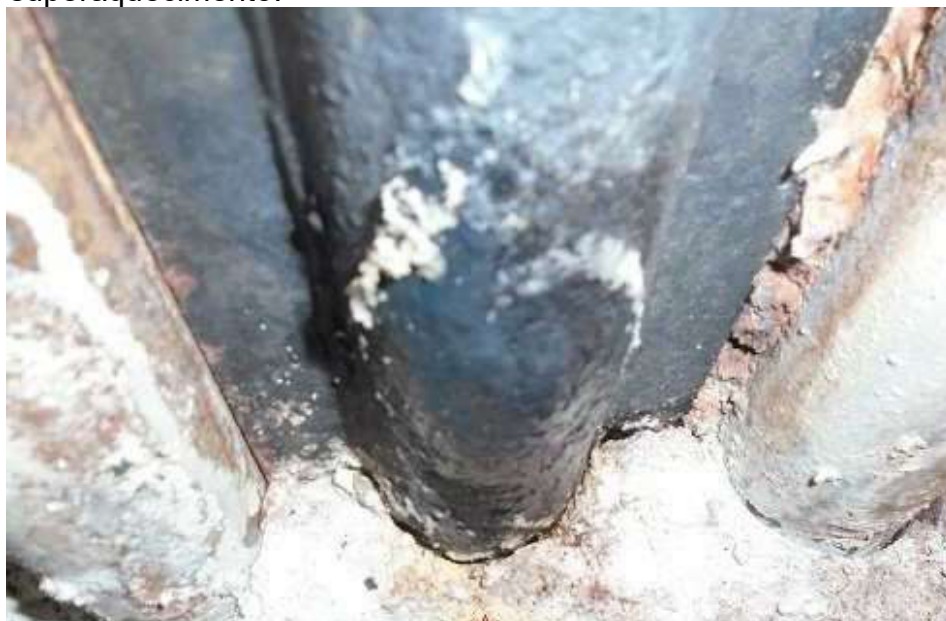
Figura 7 - Tubo de caldeira exibindo formação tipo “laranja” devido superaquecimento.
