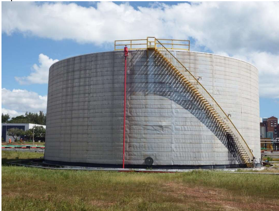
Figura 1 - Tanque de armazenamento de petróleo de alta viscosidade com sistema de aquecimento interno (serpentina) por vapor da caldeira
