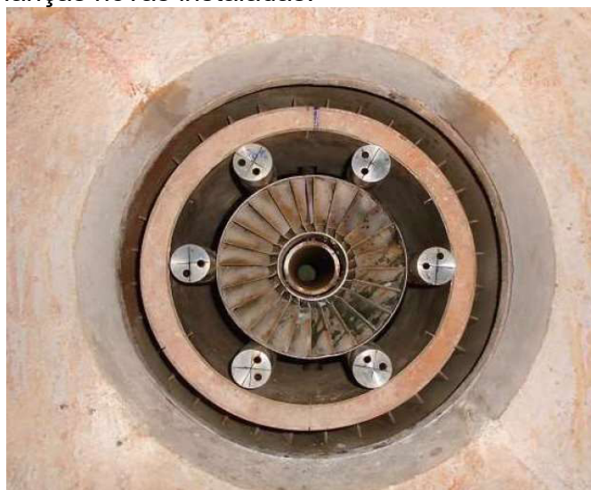
Figura 30 – Queimador da fornalha com as 6 lanças novas instaladas.
