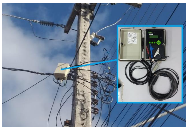
Figura 18 - Conexão do equipamento IMS modelo PowerNET P-600 G4.
