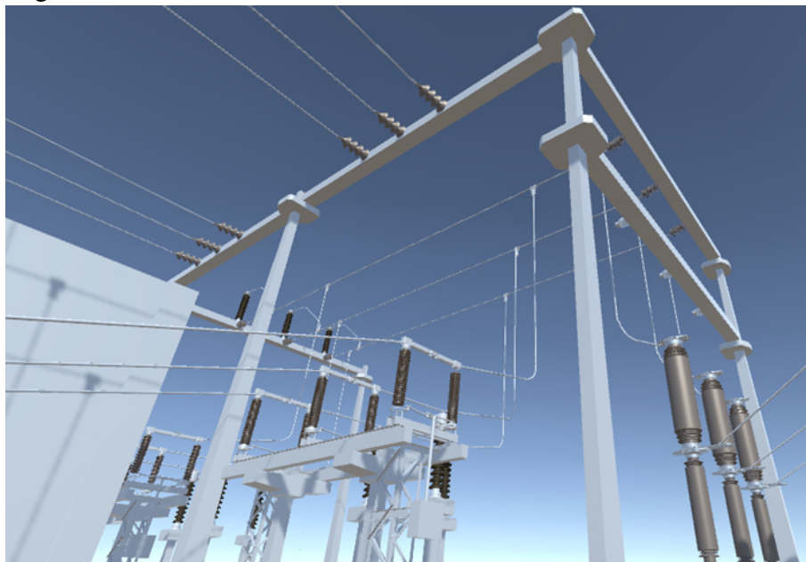
Figura 9 – Barramento de alta tensão.
