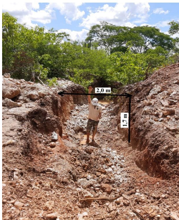
Figura 12- Trincheira com abertura de 2,0 m x 1,7m x 10 m após a limpeza da área.
