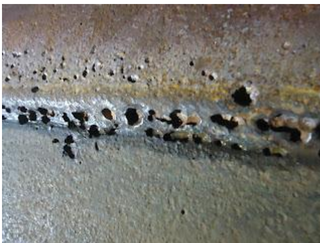
Figura 4 - Corrosão por pites
