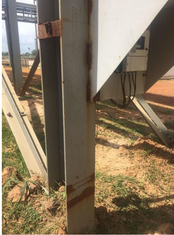
Figura 12 - Painel elétrico soldado em coluna metálica
