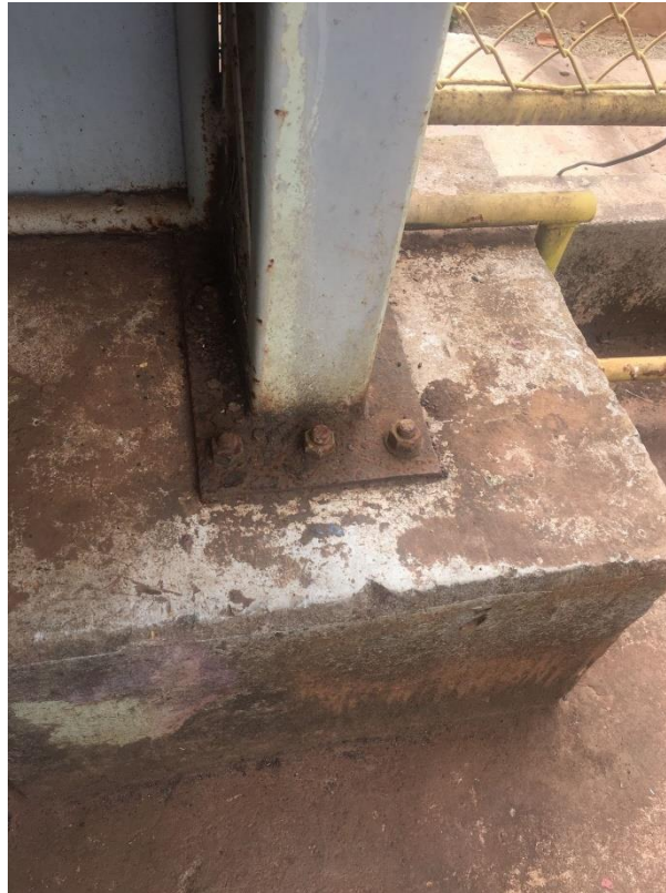
Figura 16 - Corrosão em coluna
