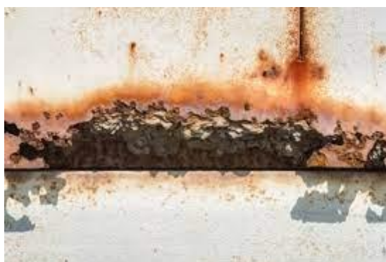
Figura 5 - Corrosão por pites
