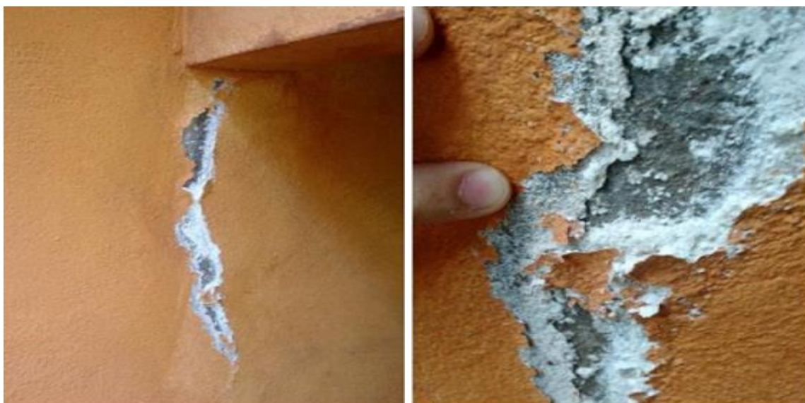
Figura 2.17 - Eflorescência com descolamento da camada de pintura. (a) eflorescência sob elemento estrutural; (b) detalhe da manifestação.
