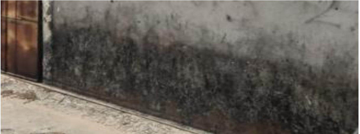
Figura 4.36 - Bolor em rodapé da parede externa.
