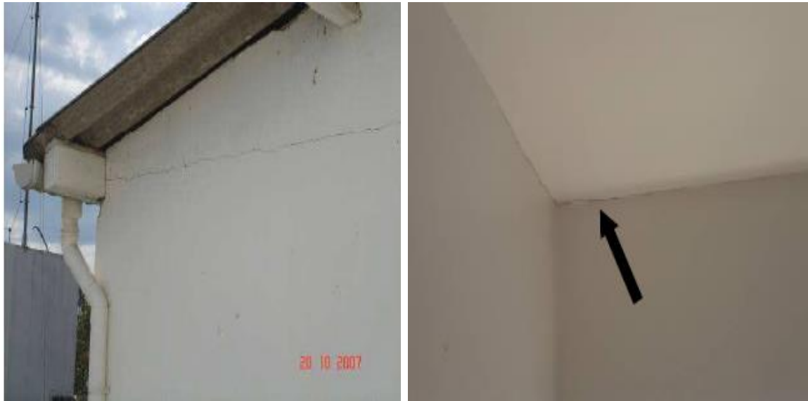
Figura 2.4 - Movimentação térmica da laje de cobertura com formação de fissura na interface laje/alvenaria
