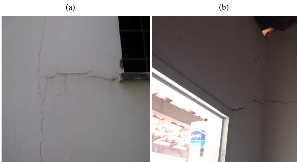
Figura 2.10 - (a) Fissura em vão de janela pela ausência de contraverga; (b) Fissura em vão de porta pela ausência de contraverga.
