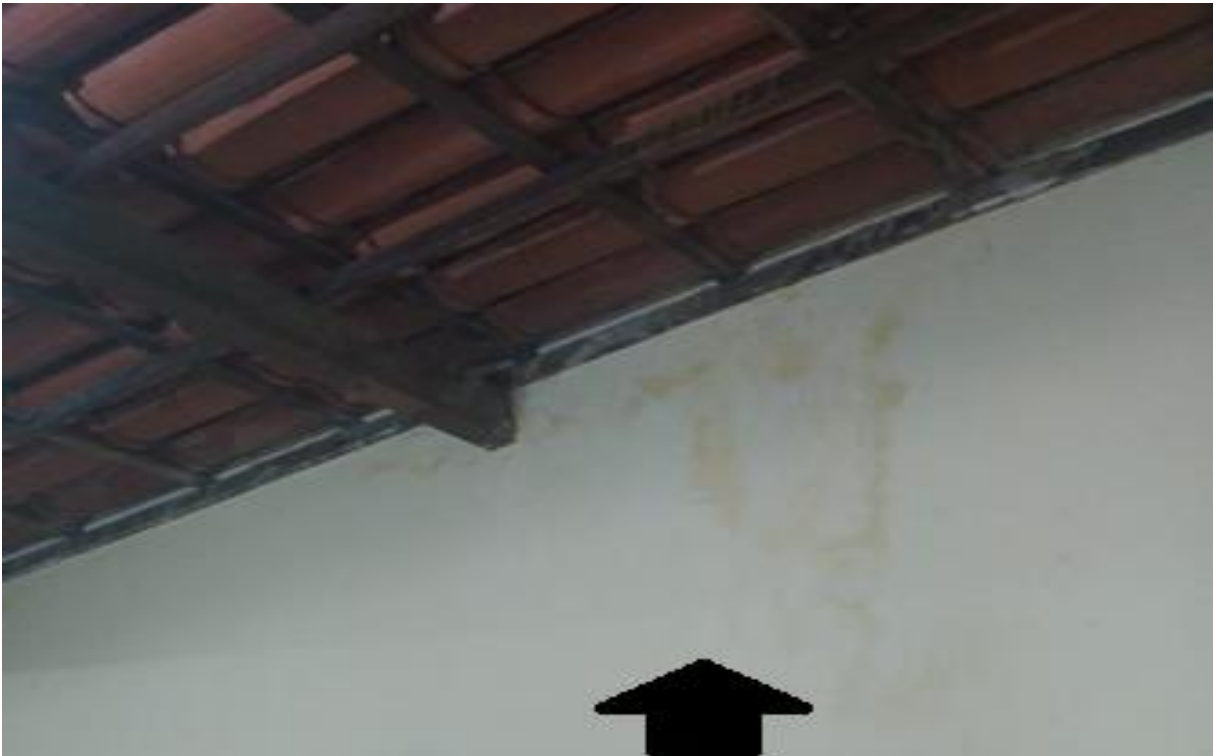
Figura 4.35 - Mancha de umidade.
