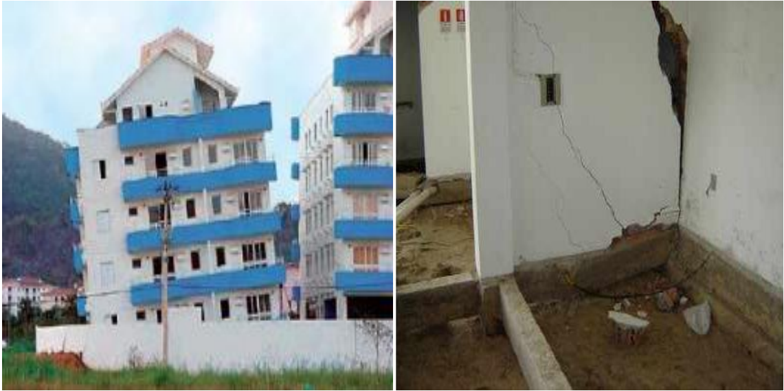
Figura 2.8: (a) Recalque em prédio em Santa Catarina devido a movimentação dos solos; (b) Recalque diferencial ocasionado pela ausência de sondagem na fundação.
