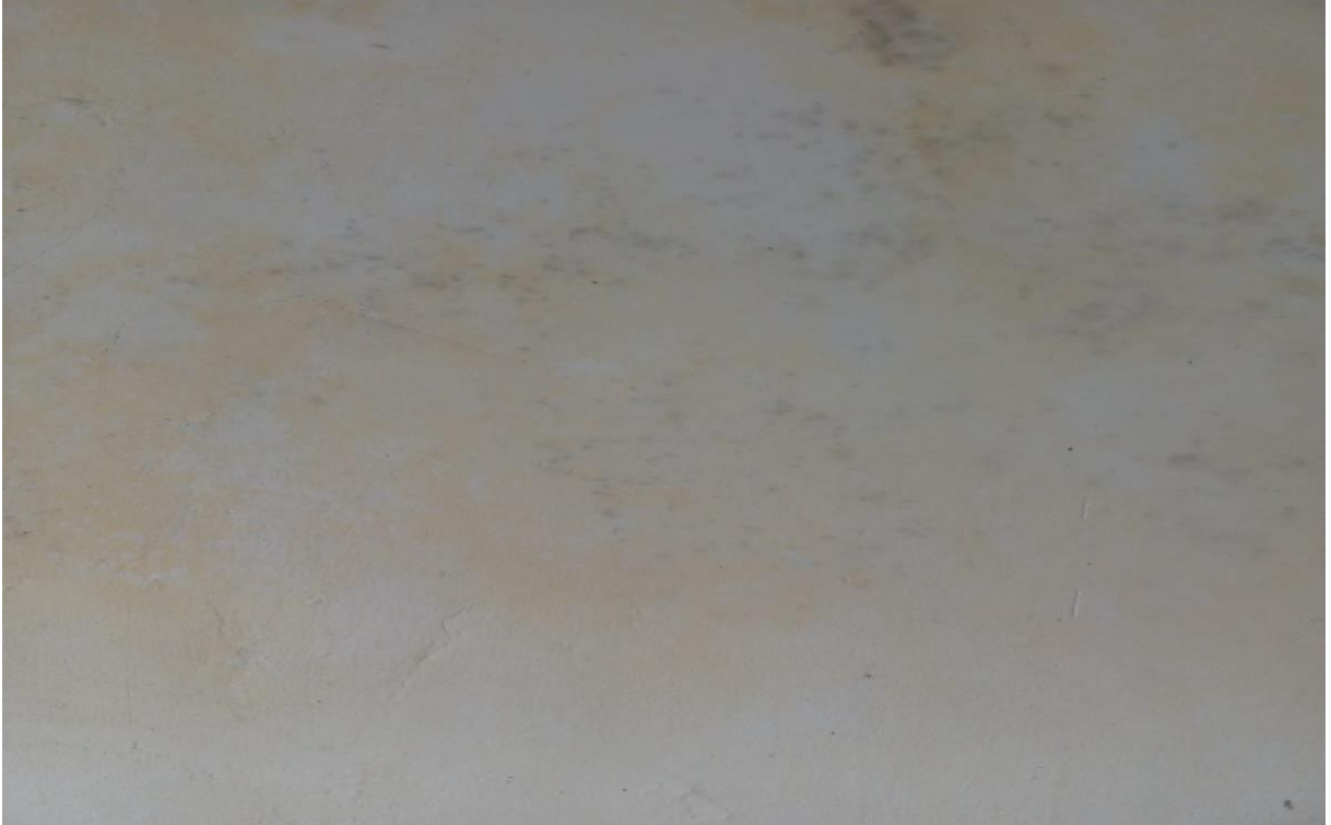
Figura 4.34 - Manchas em cor amarela e pontos em escuros
