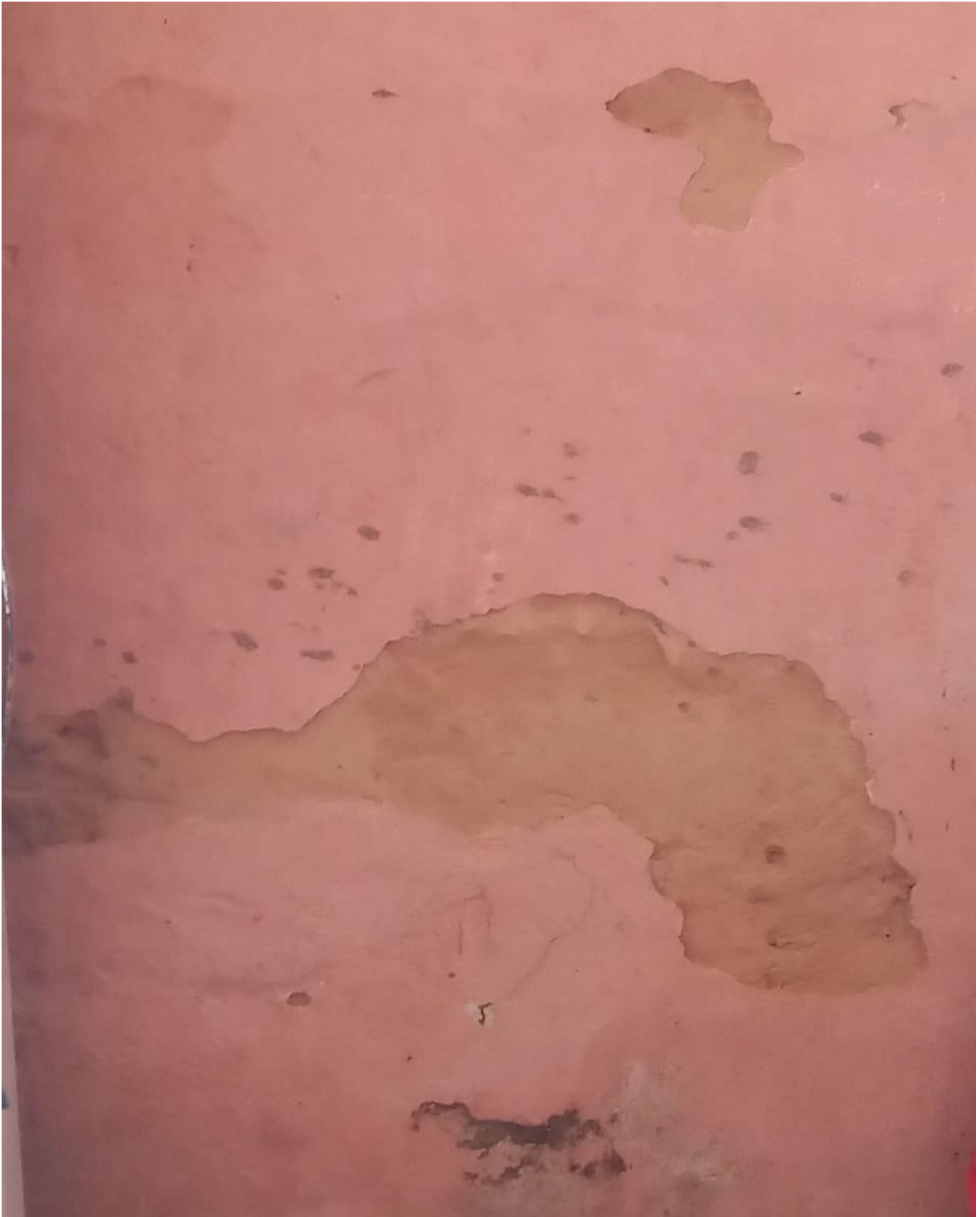
Figura 4.33 - Pulverulência com descascamento de tinta
