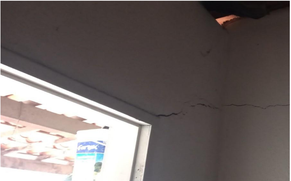
Figura 4.23 - Trinca na altura da abertura da porta
