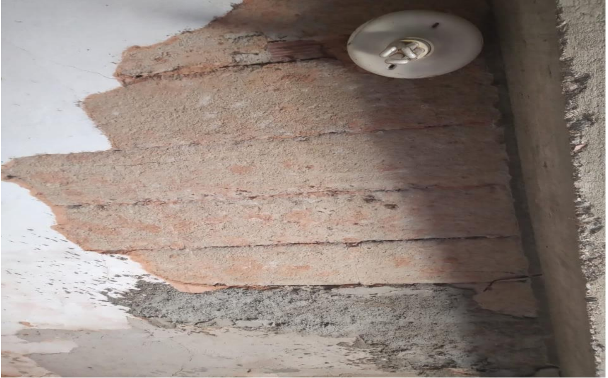
Figura 4.31 - Desplacamento de laje
