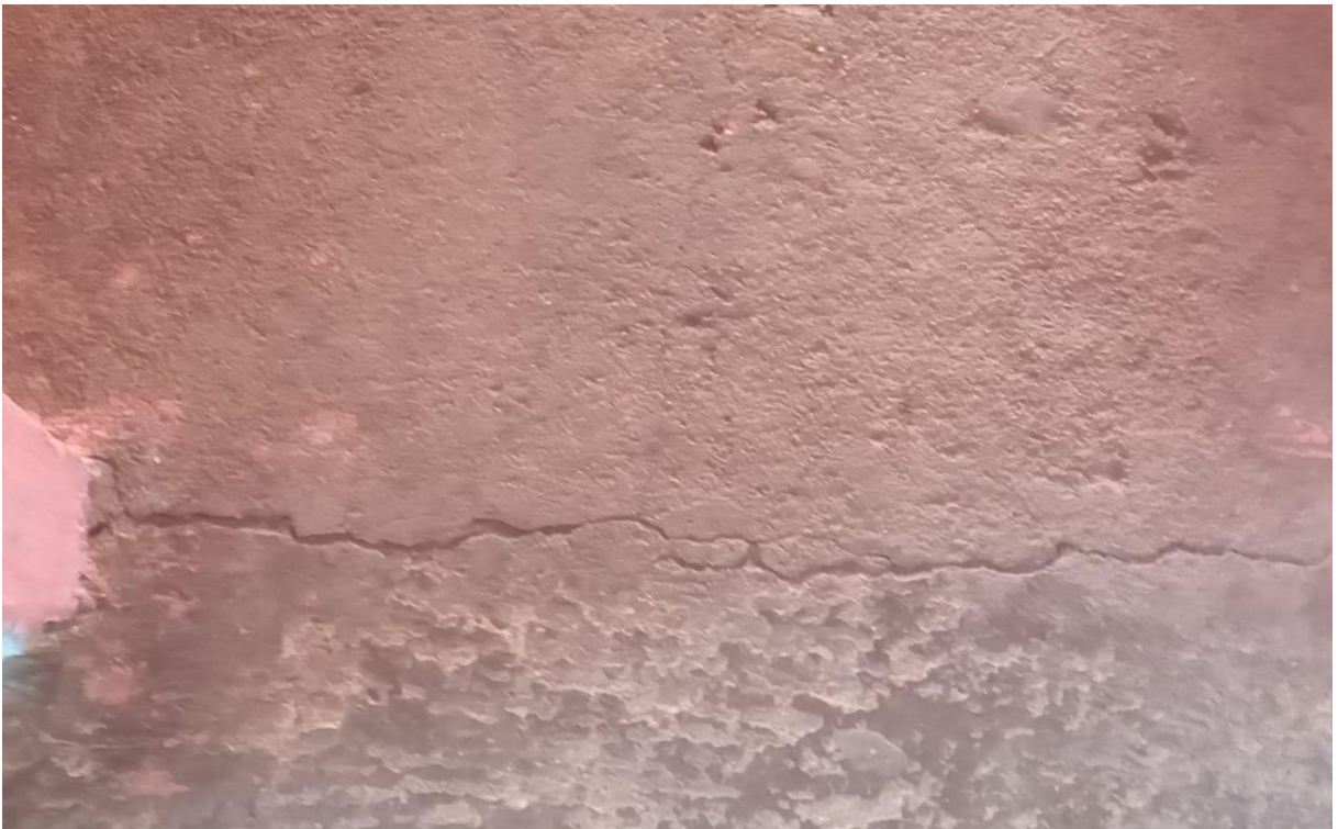
Figura 4.28 – Trinca superficial em parede argamassada
