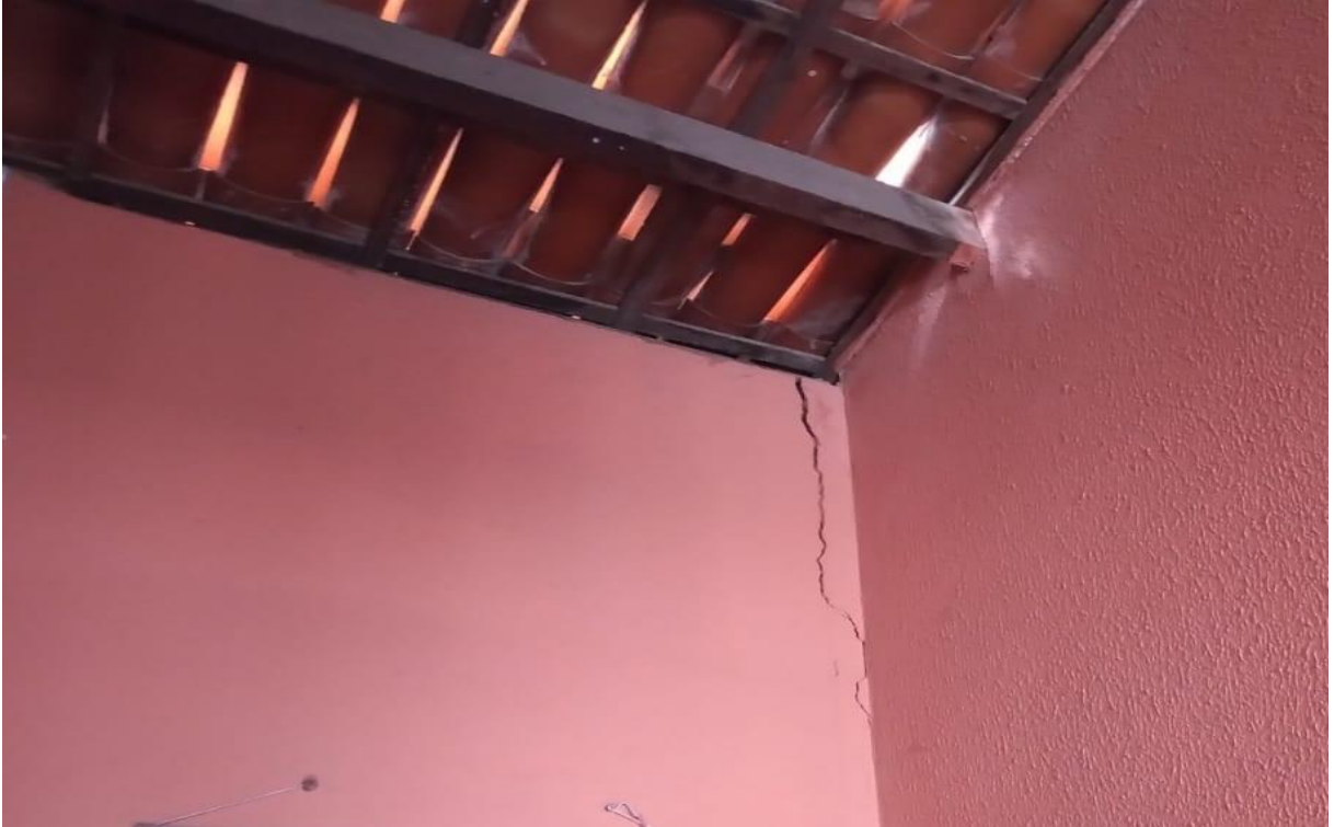
Figura 4.20 - Trinca abaixo do telhado
