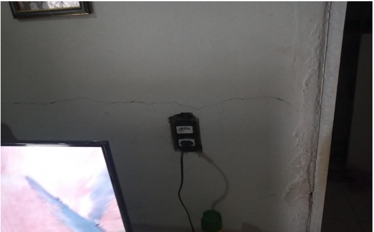
Figura 4.26 - Fissura acima da tomada elétrica
