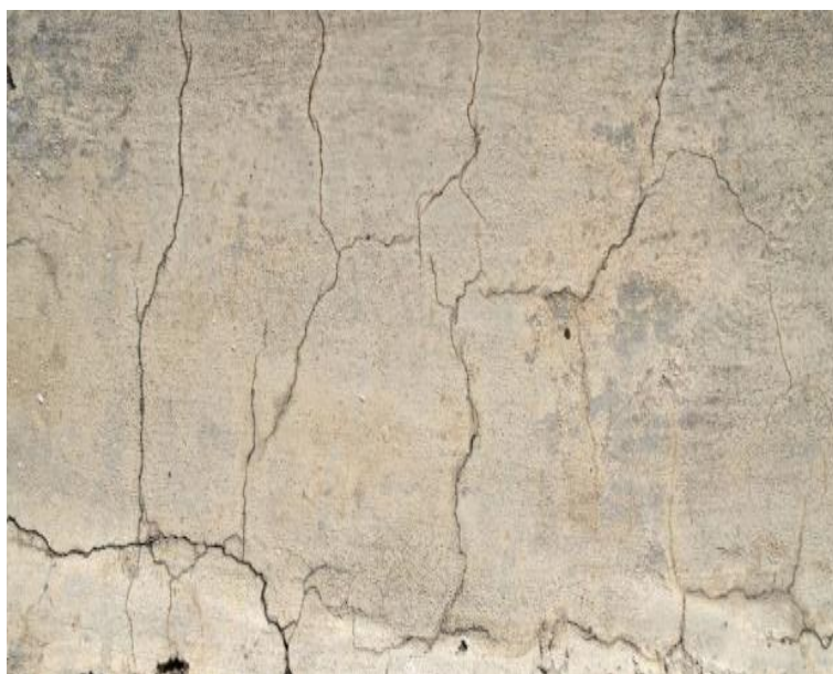
Figura 2.11 - Trincas ocasionadas pela retração do cimento.
