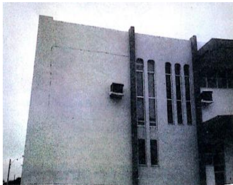
Figura 2.5 - Fissuras na interface entre a alvenaria e a estrutura, devido a movimentações térmicas
