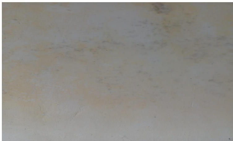
Figura 2.18 - Manchas de cor amarelada decorrentes de uma infiltração na parte exterior da parede
