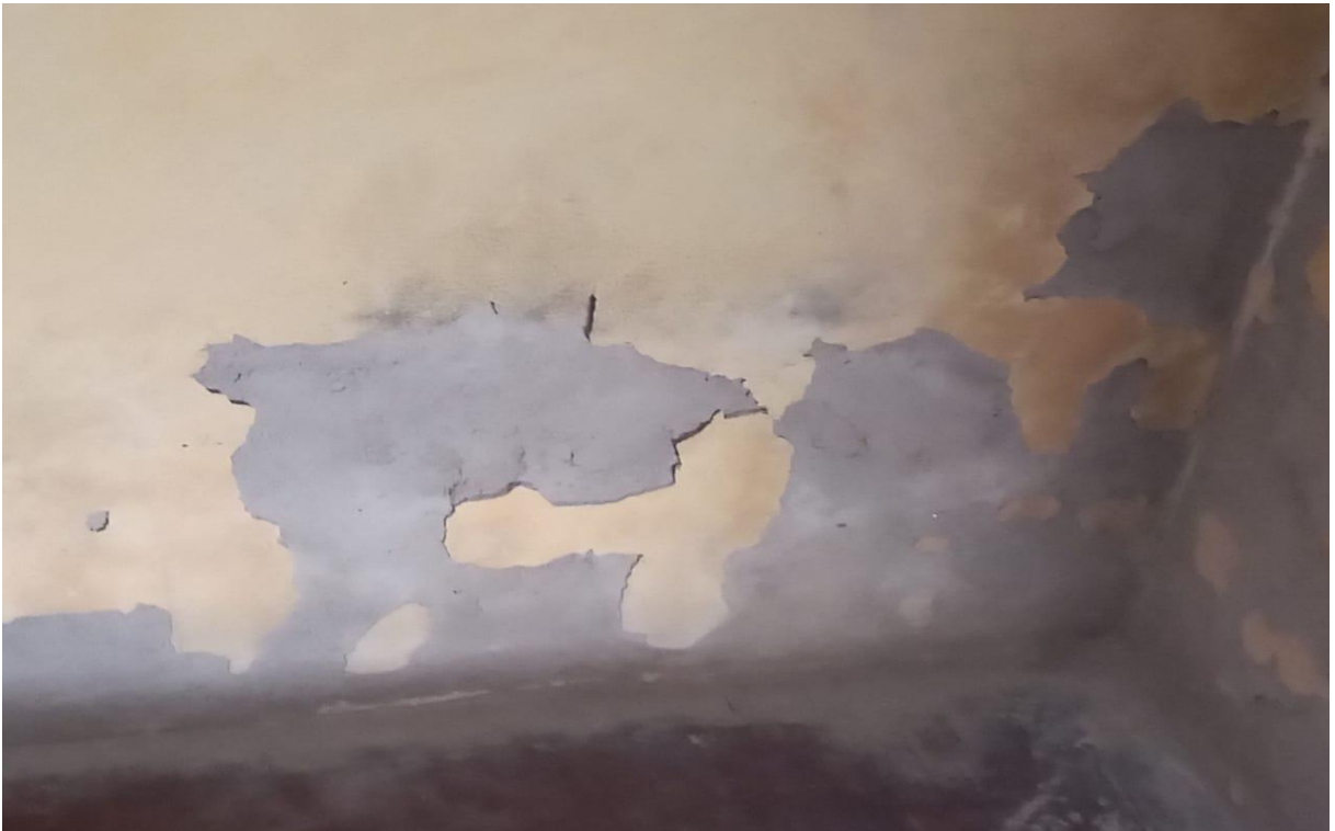
Figura 4.32 - Pintura no rodapé da parede descascada
