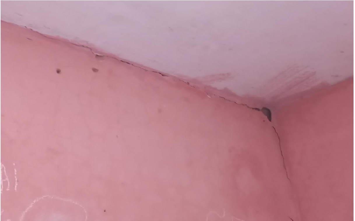
Figura 4.22 - Trinca na interface alvenaria e laje
