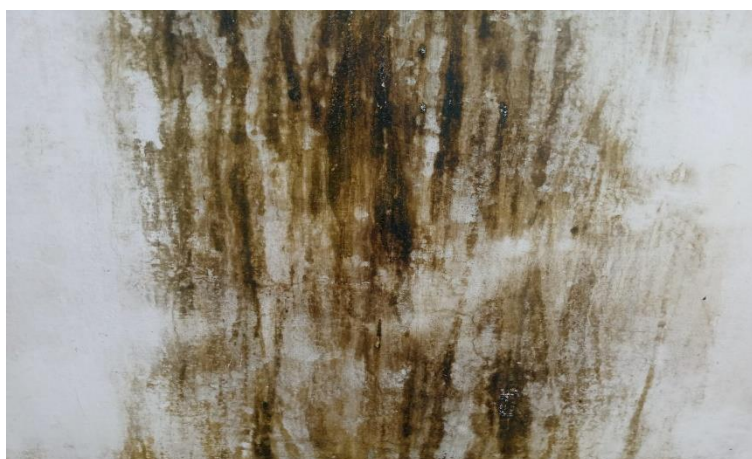
Figura 2.19 - Mancha verde decorrente do excesso de umidade produzido pela chuva.
