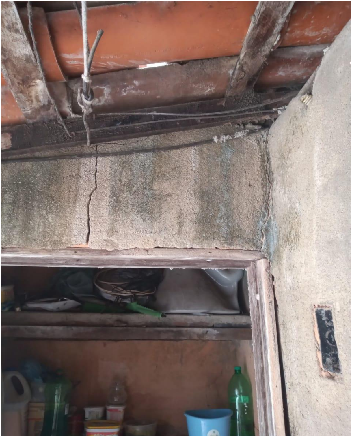
Figura 4.24 – Trinca acima da abertura da porta
