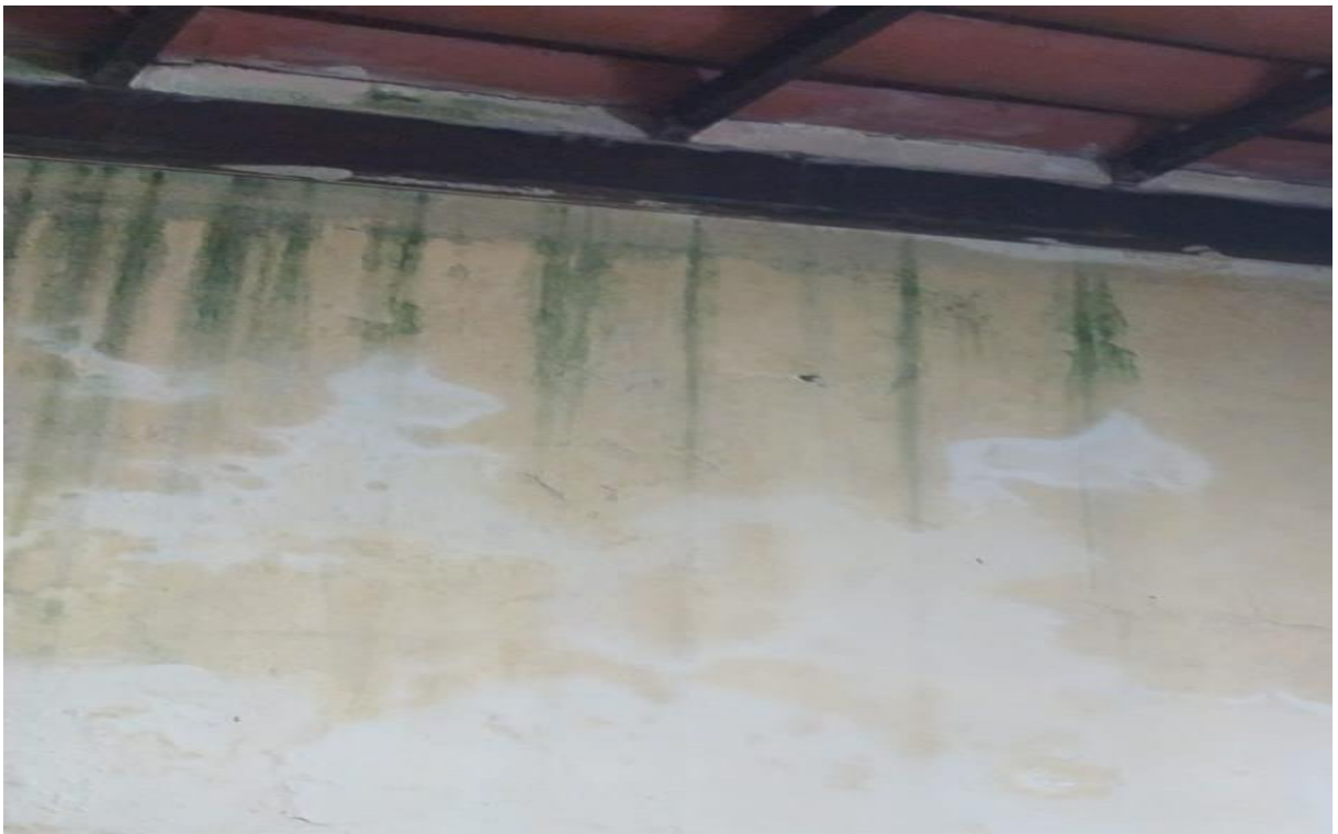
Figura 4.30 - Infiltração em parede com presença de fungos
