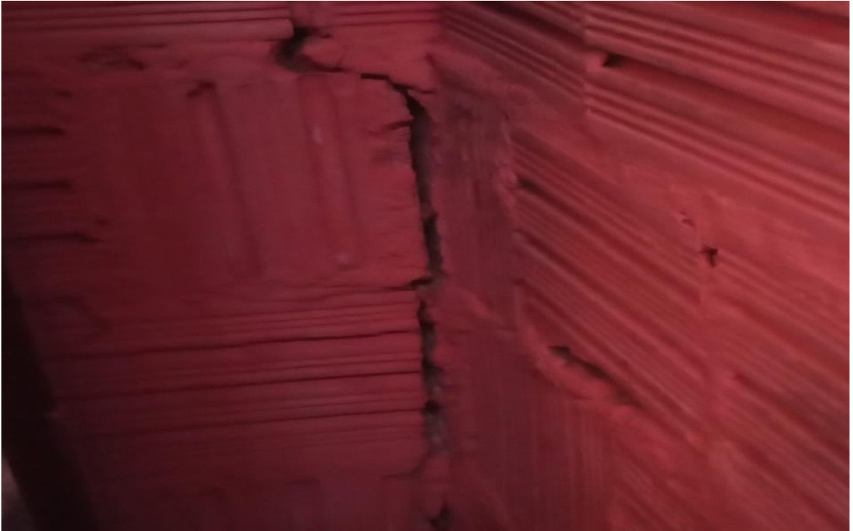
Figura 4.27 - Rachadura no encontro de duas paredes de alvenaria
