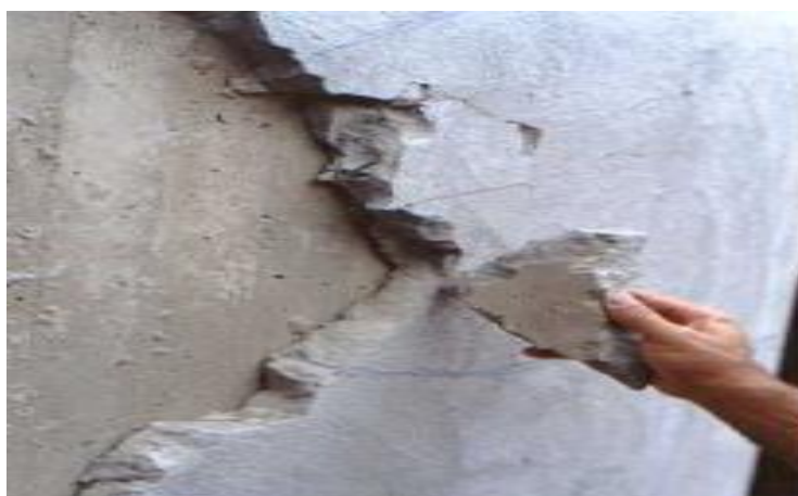
Figura 2.14- Descolamento do revestimento
