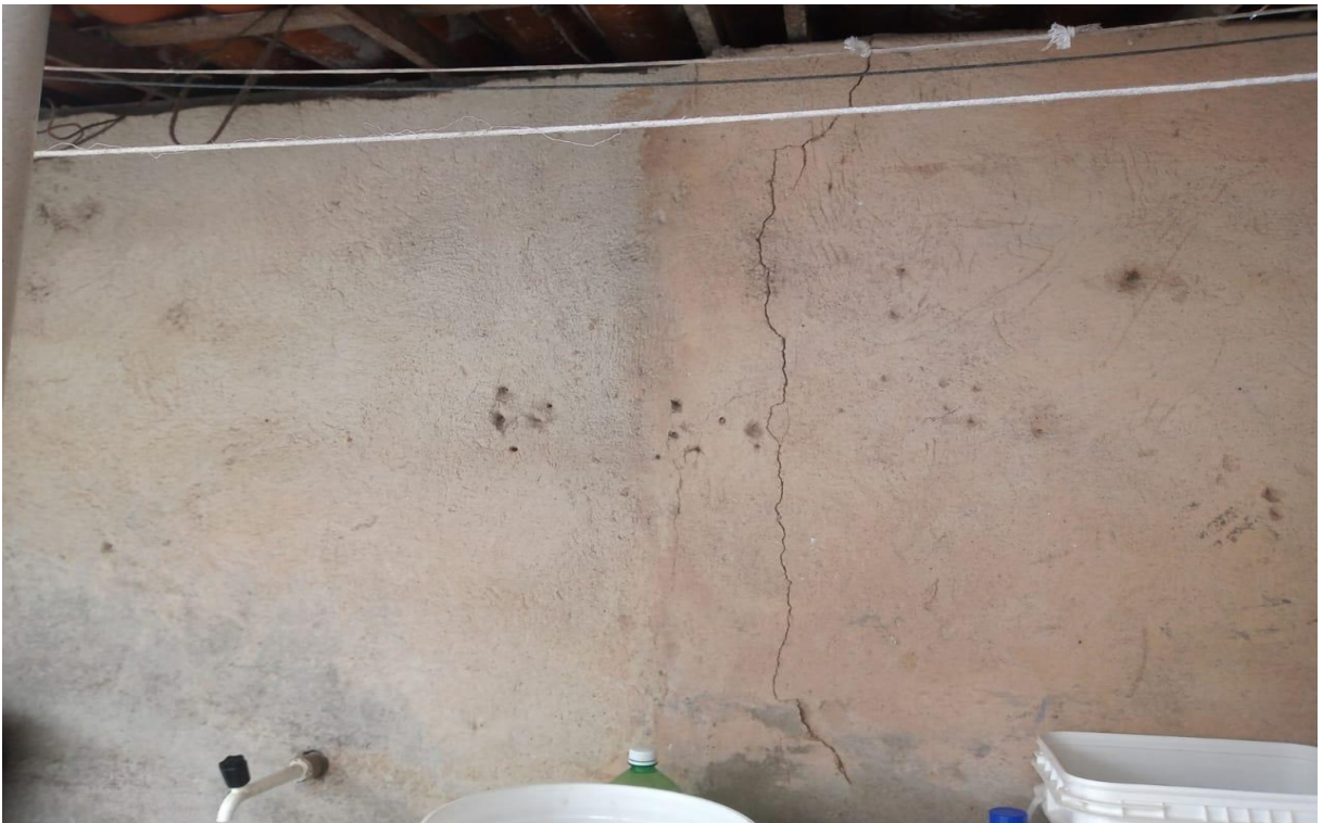
Figura 4.21 - Trinca em revestimento argamassado
