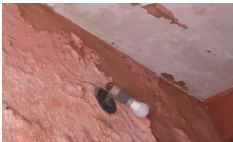
Figura 2.15 - Descascamento da pintura seguido de desagregação
