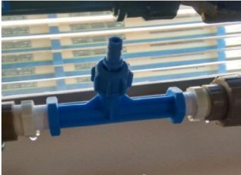
Figura 6 – Tubo de Venturi.
