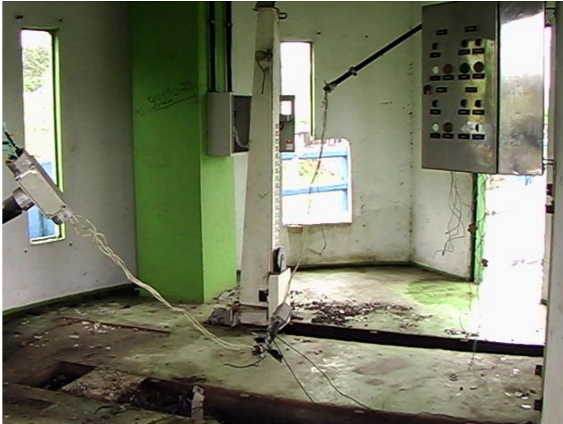
FIGURA 5.6 – Acidente com a Barragem Norte (Vale do Itajaí – SC) – março/2005
