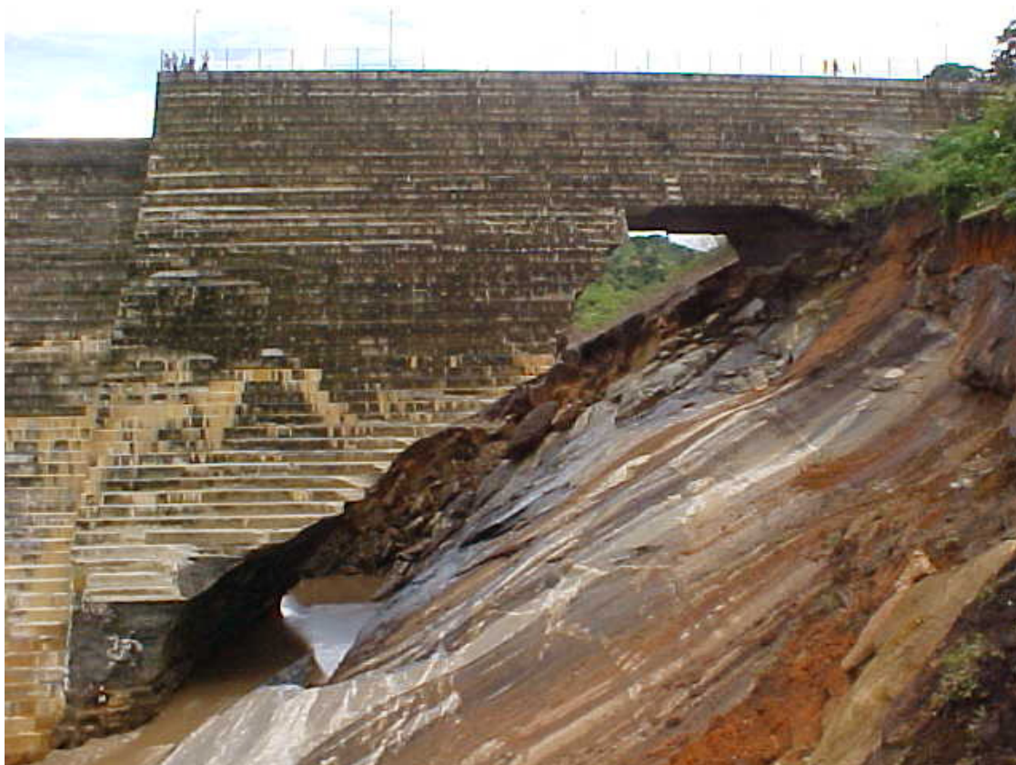
FIGURA 5.5 – Acidente com a Barragem Camará (Alagoa Grande -PB) – junho/2004
